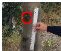
Fig. 4.79. Grupa II de deteriorare
