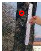
Fig. 4.78. Grupa I de deteriorare
