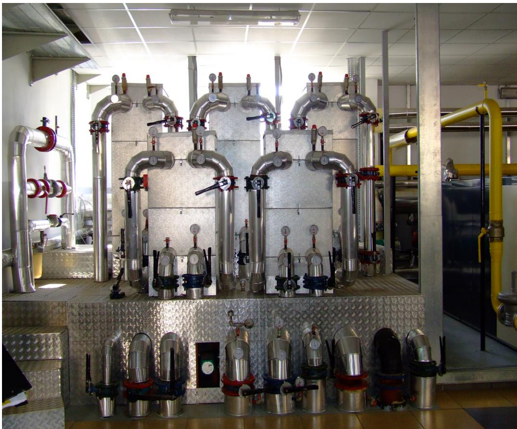
Figura 2.10. Ansamblul de pompe, racorduri și schimbătoare de căldură
