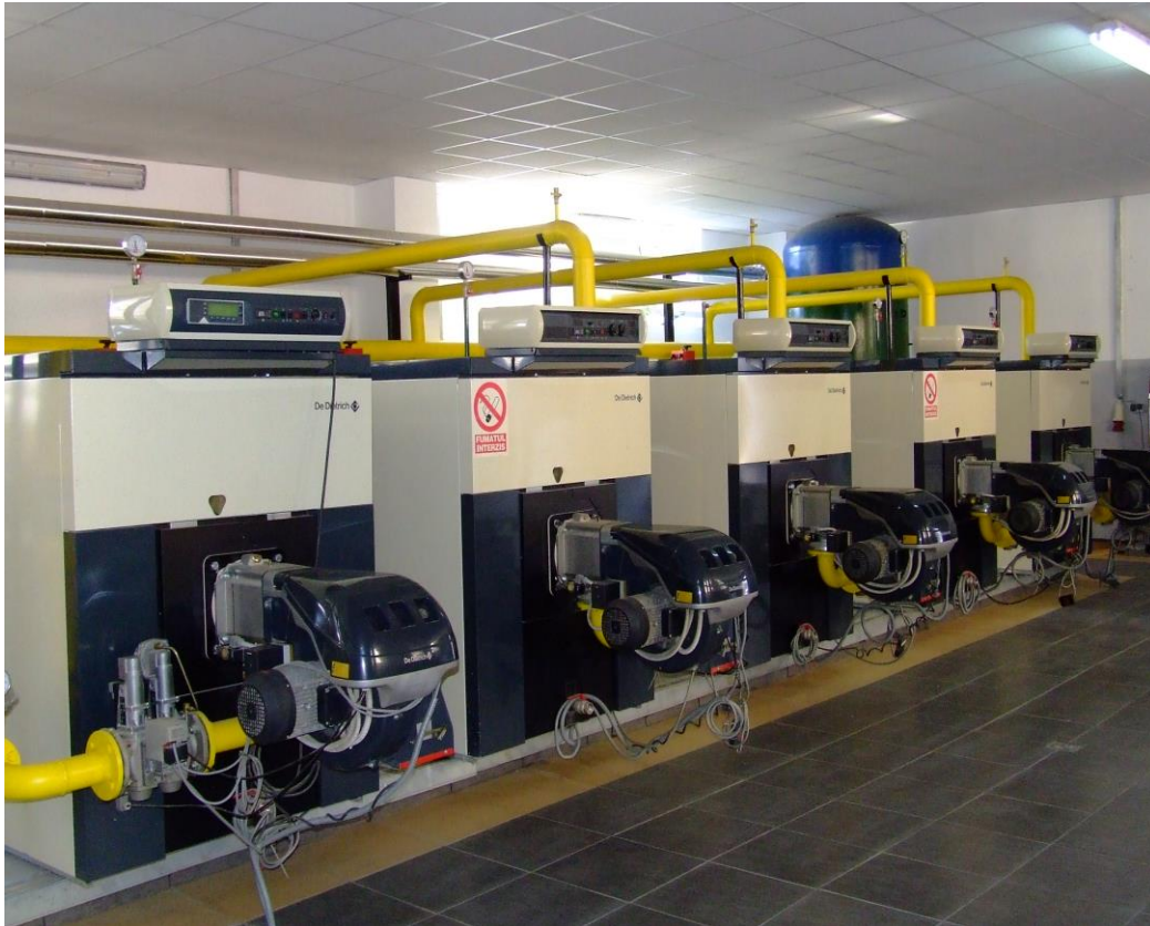
Figura 2.9. Sala cazanelor pentru cogenerare
