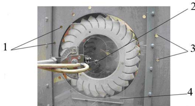
Figura 6.12. Fragment din peretele lateral al carcasei cu fereastra de acces a tubului Pitot-Prandtl în interiorul nepaletat al rotorului 1- orificiu pentru accesul sondei la aspirația aerului în rotor; 2- orificiu pentru accesul sondei în spațiul nepaletat al rotorului; 3- orificiu pentru accesul sondei la refularea aerului din rotor; 4- placă obturantă transparentă
