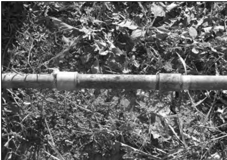
Fig.A3.2. Conexiune din instalație care poate fi considerată o sursă nedorită de zgomote
