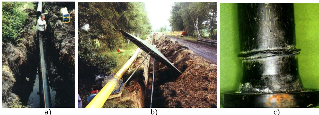
Figura 2.27 Exemple: Cauze de apariție a defectelor de sudare [61] a) susținerea necorespunzătoare a țevilor; b) protecție insuficientă la intemperii; c) parametrii de sudare necorespunzători
