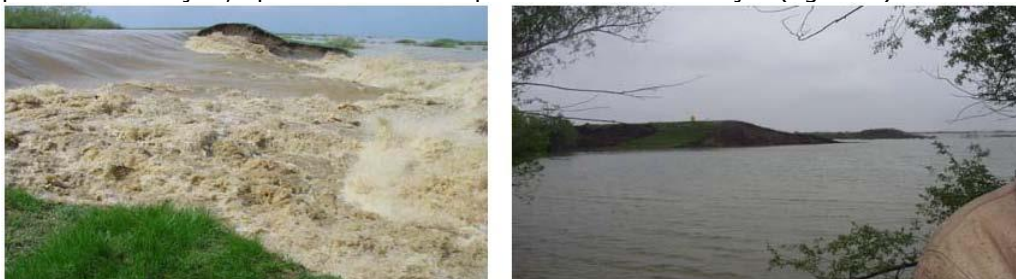
Fig.5.18. - Ruperea digului în zona Foieni – Cruceni (2005)
