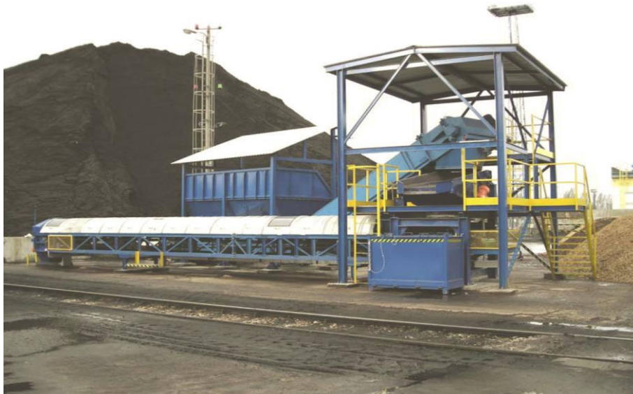
Fig. 3. 18. Instalație de mixare a biomasei cu cărbune [75]
