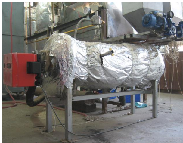
Fig. 4.13. Preîncălzitor de aer cu arzător de pornire Riello 40 GS3
