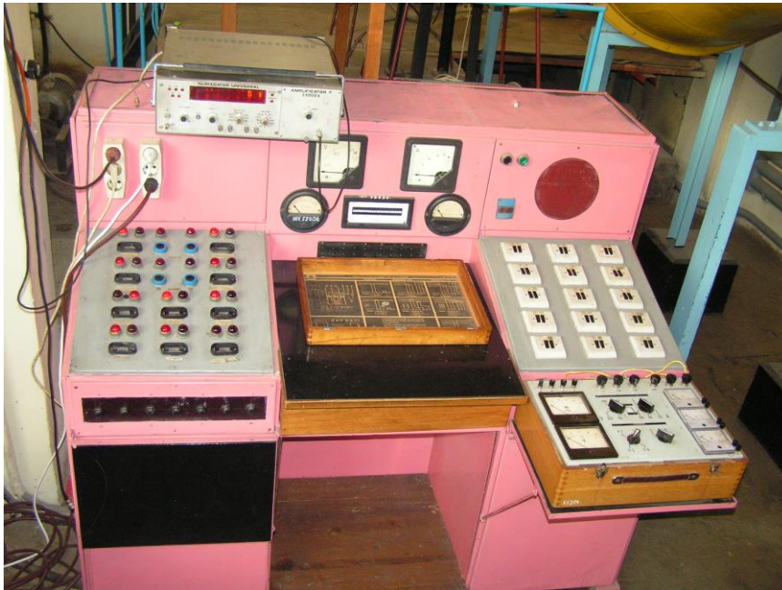
Fig.5.16 Panoul electric de comandă
