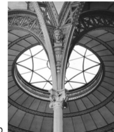
fig.3.6.2g Bibliothèque Nationale (vezi și 2.2.2k) - spațiul cuprins între clădirile existente este acoperit printr-o alăturare de nouă cupole din elemente ceramice cu luminator de sticlă, care descarcă pe arce din fier forjat preluate de coloane filigrane din fontă. Întregul sistem structural, stâlpi, arce, cupole luminator, participă, alături de galeriile de acces la rafturi ce înconjoară incinta, la definirea și punerea în valoare a spațiului.
