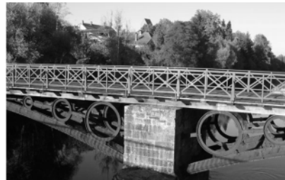
fig.2.2.1a10 Pont du Carrousel , PARIS, Franța (1823-1838) - ing. Antoine-Rémy Polonceau - o construcție ce poate fi considerată remarcabilă în domeniul structurilor în arc, deși forma circulară a componentelor care leagă arcul de puntea de călcare nu denotă o bună cunoaștere a felului în care lucrează metalul.
