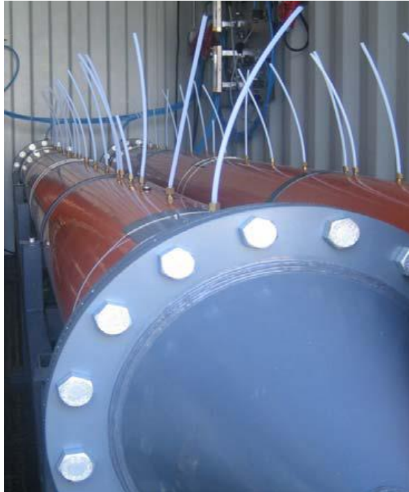
Fig. 5.12. Conductă PVC cu flanșe aplicate la intrare și ieșire și ștuțuri pentru prelevarea de probe [21],[24]
