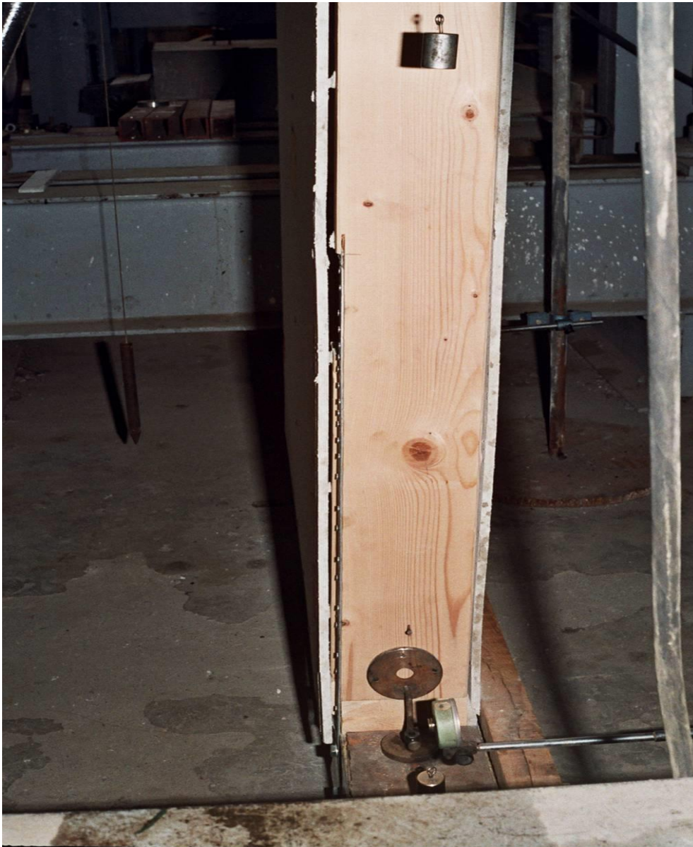
Fig 8.10 - Desprinderea plăcii Vidiwall de pe montanți la 1700 daN.
