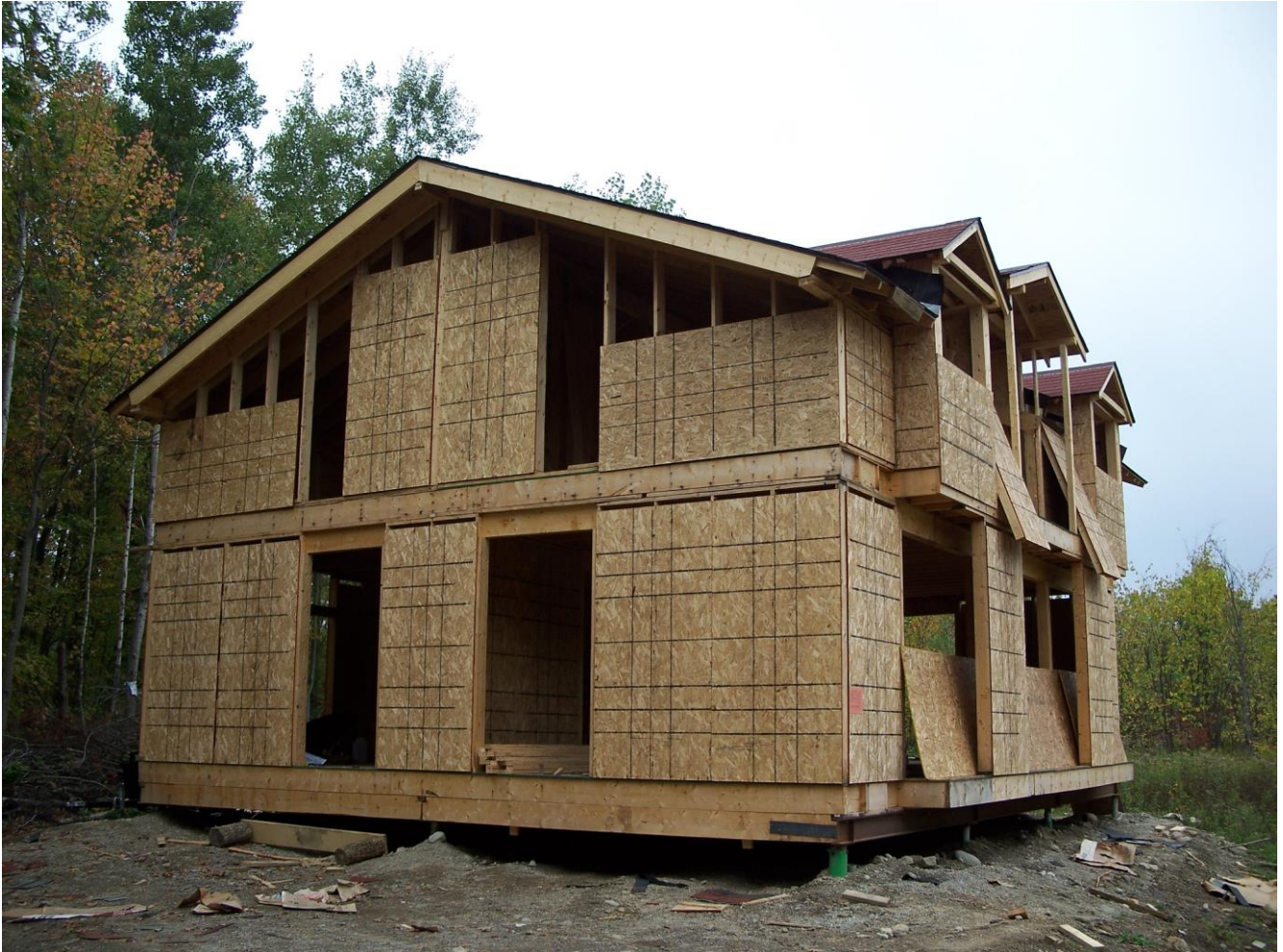
Fig. 9.5 – Structura unei case din lemn proiectată și executată de autor în Mallorytown, Canada(2007).
