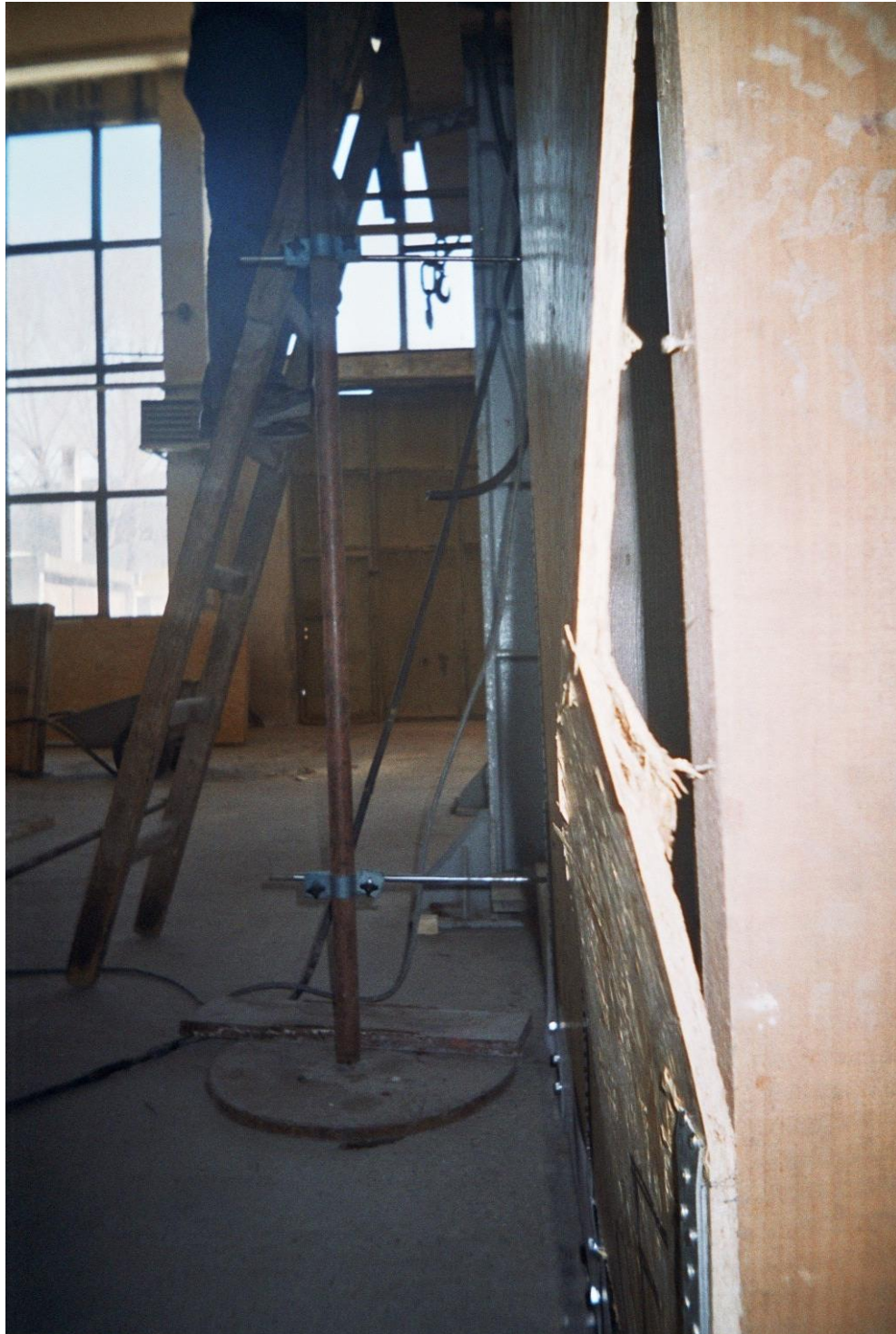
Fig.7.11 - Detaliu in zona comprimata a panoului PO2 la rupere.
