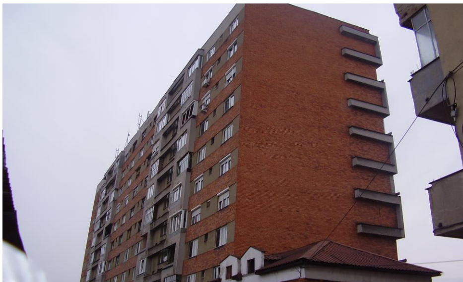
Figura 7.19 Clădire cu pierderi mari de căldură – vedere
