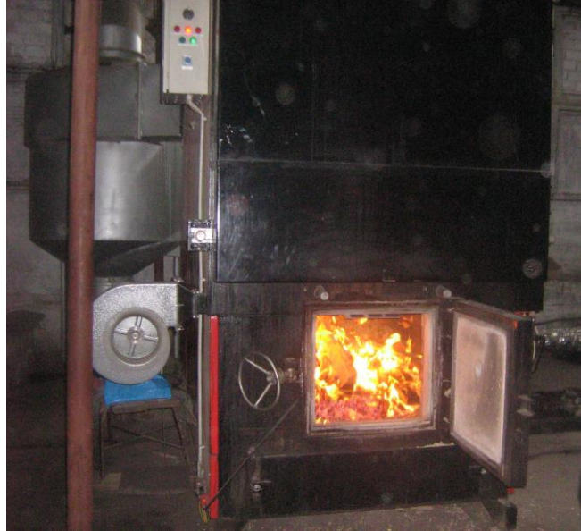
Figura 6.20 Cazan de apă caldă P_t = 1.75 MW
