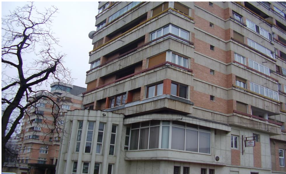
Figura 7.21 Clădire cu pierderi moderate de căldură - vedere
