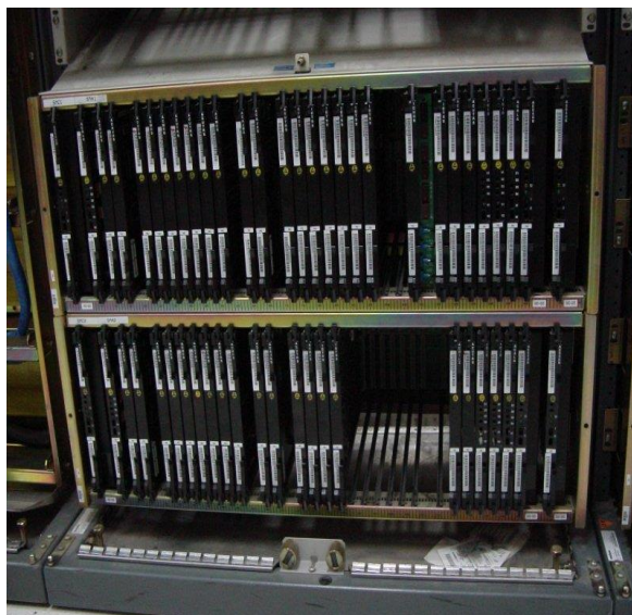
Figura 7.3: Dulap cu rack-uri (sertare) pentru plăcile comutaționale ale centralei digitale
