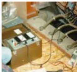
Figura 8.3. Măsurarea rezistenței de izolație cu megohmetru
