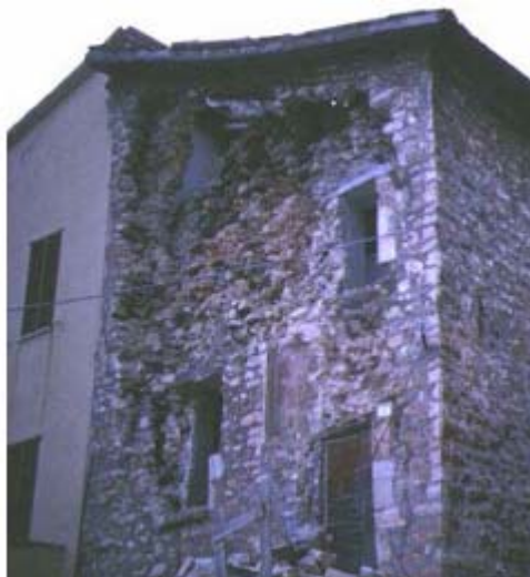
Fig. 4.14. Dislocarea unor porțiuni din zidărie [2]
