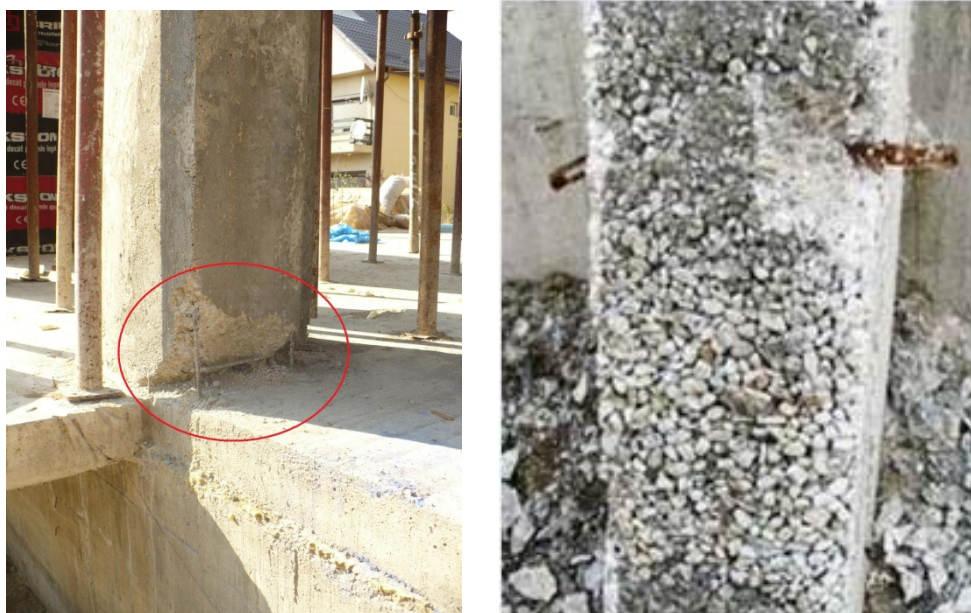
Fig. 2.2. Lipsa acoperirii cu beton la baza stâlpului, segregarea betonului în stâlp
