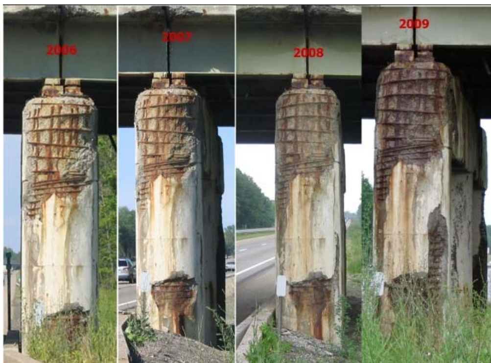
Fig. 2.6. Propagarea coroziunii armăturilor în timp datorată prezenței clorurilor, la un pod din New York State [85]
