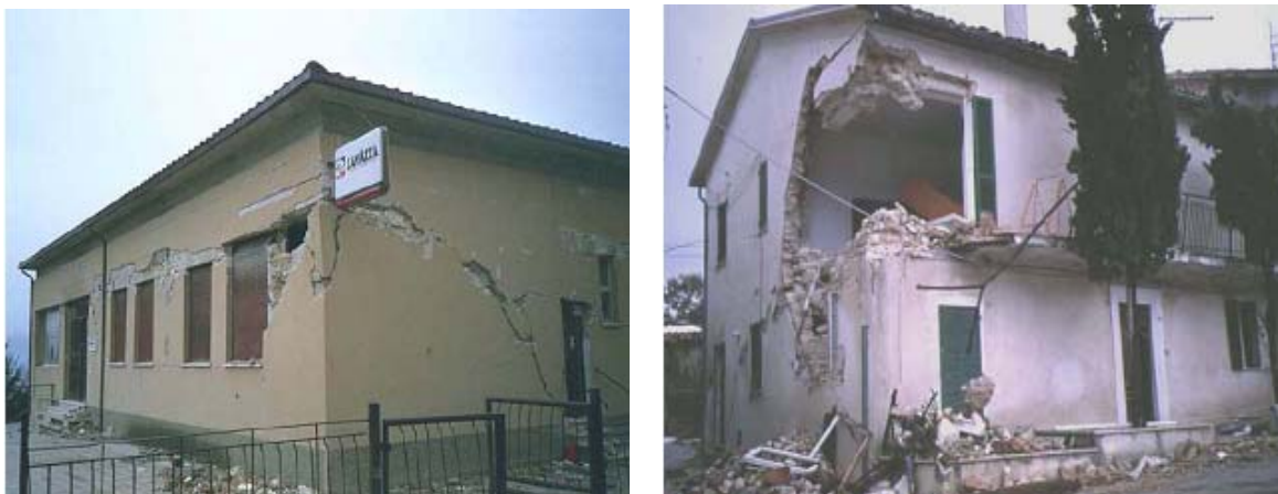
Fig. 4.12. Colapsul colțurilor fațadei [2]
