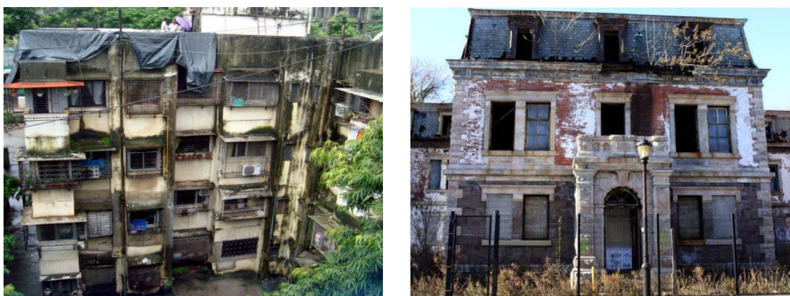
Fig. 2.3. Clădiri întreținute necorespunzător [84]
