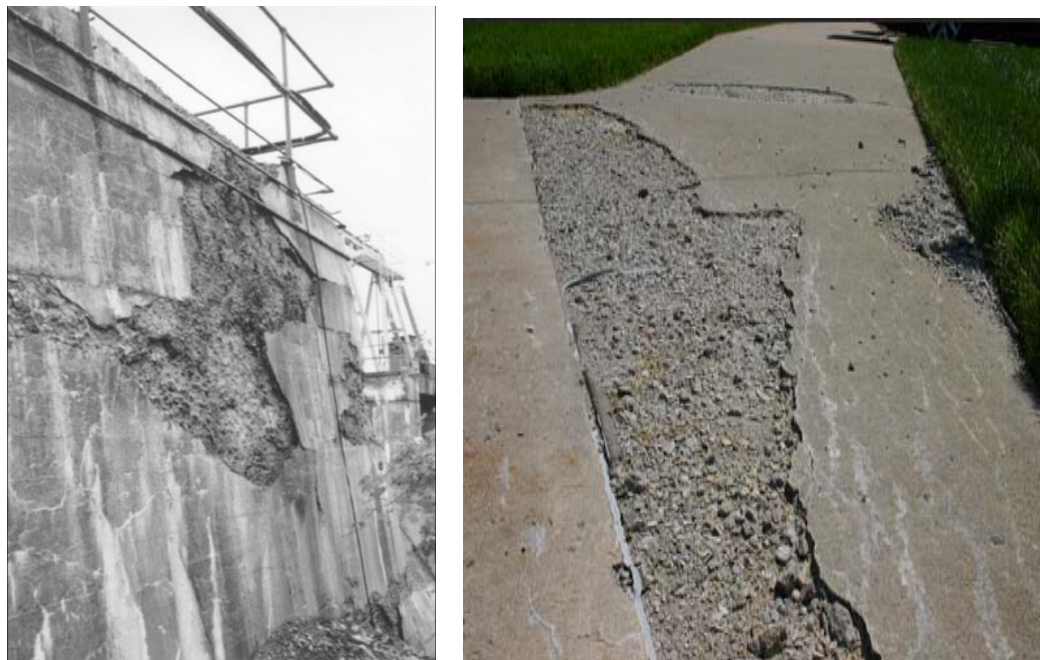
Fig. 2.8. Distrugerea betonului datorită fenomenului de îngheț-dezghet repetat
