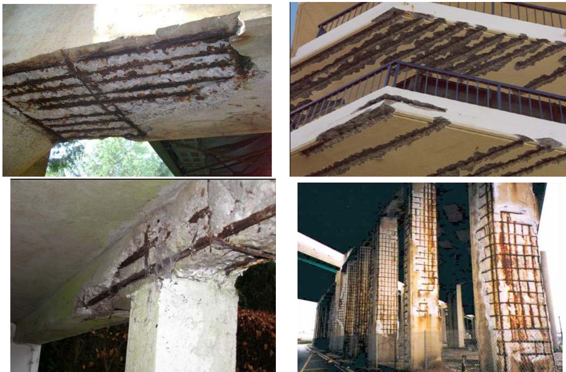
Fig. 2.5. Coroziunea armăturilor datorată carbonatării betonului
