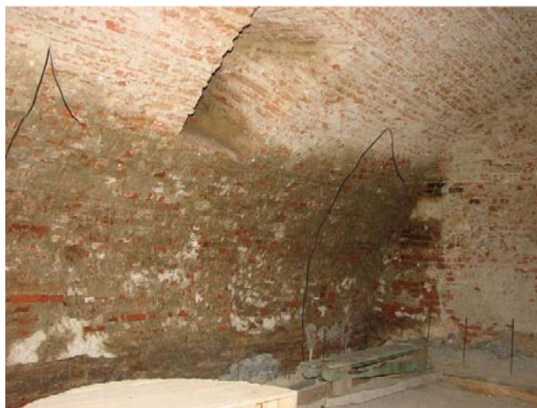
Fig. 2.4. Efectul umidității din teren asupra construcțiilor din zidărie
