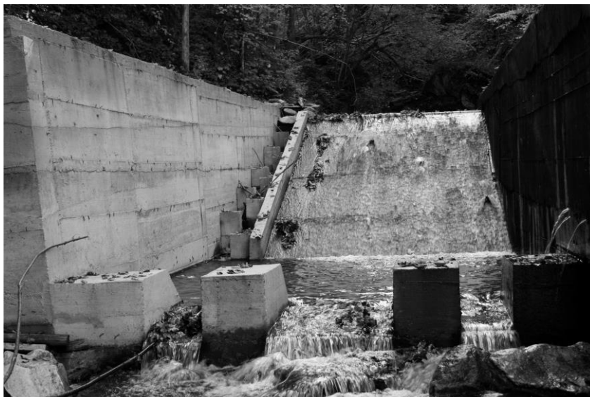
Figura 6.14. Captarea Sebeșel I, nivel de apă scăzut pe radierul de beton, chiar și în cazul în care MHC este oprită. Scara de pești nu este alimentată cu apă, 25.10.2012. Foto: P. Molnar.
