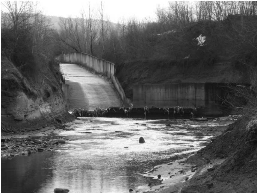
Figura 6.23. Râul Sebeș, ocolind lacul-tampon Zervești printr-un canal de beton. 24.01.2013. Foto: P. Molnar.
