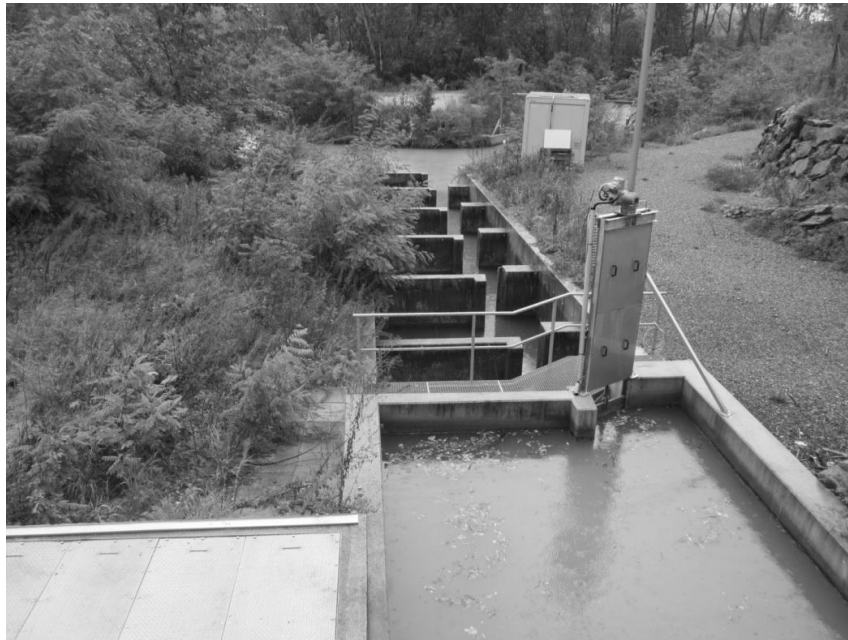
Fig. 4.7. Pasaj cvasi-natural pe fluviul Dunărea la Melk în Austria, racord la bieful amonte printr-un pasaj tehnic cu fantă verticală (oprit temporar). Vedere din amonte. Foto: P. Molnar.
