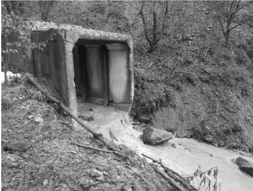
Figura 6.21. Râul Slatina curgând printr-o conductă casetată sub deponul materialului excavat și depozitat în albia râului. Foto: P. Molnar.
