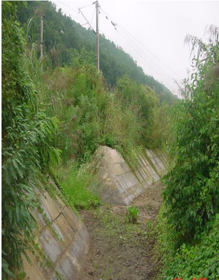
Fig. 6.5 Consolidare terasament cu șanț de beton monolit și dale prefab. pe partea dreaptă a terasam. km.574+595
