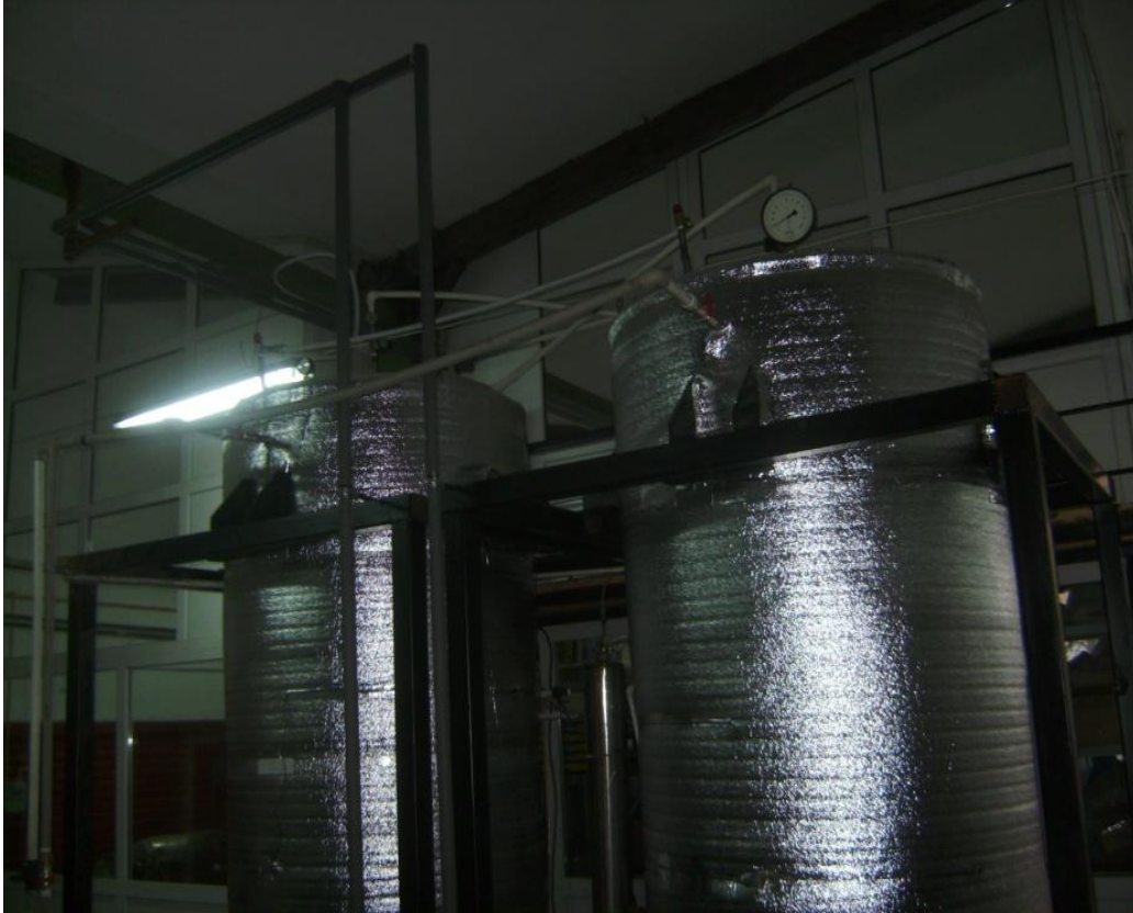
Figura 5.12 – Instalația de fermentare anaerobă – vedere de ansamblu
