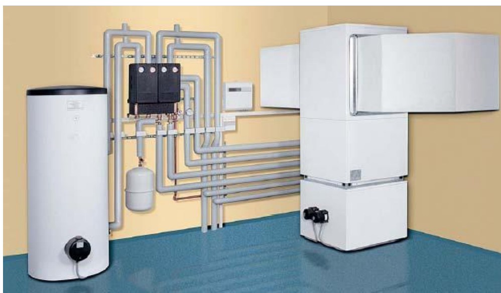
Figura 5.2 Sistem pentru încălzire locuință și apă caldă menajeră cu pompă de căldură aer-apă DIMPLEX LI11AS(R), LI16AS(R) [59]
