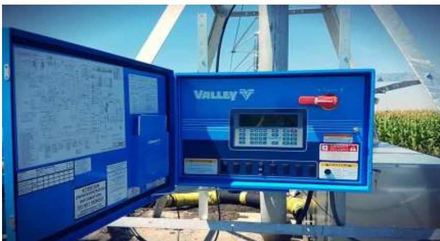
Figura 61 Panou de control general al instalației de irigație tip pivot central
