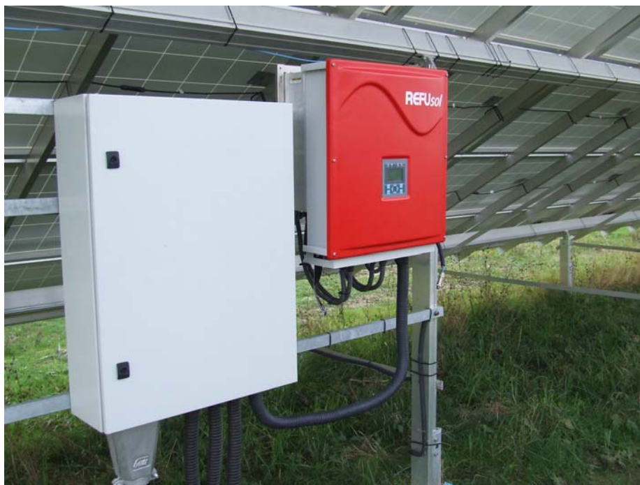
Fig.5.19. Inverter REFUSOL amplasat în Centrala Fotovoltaică Giroc
