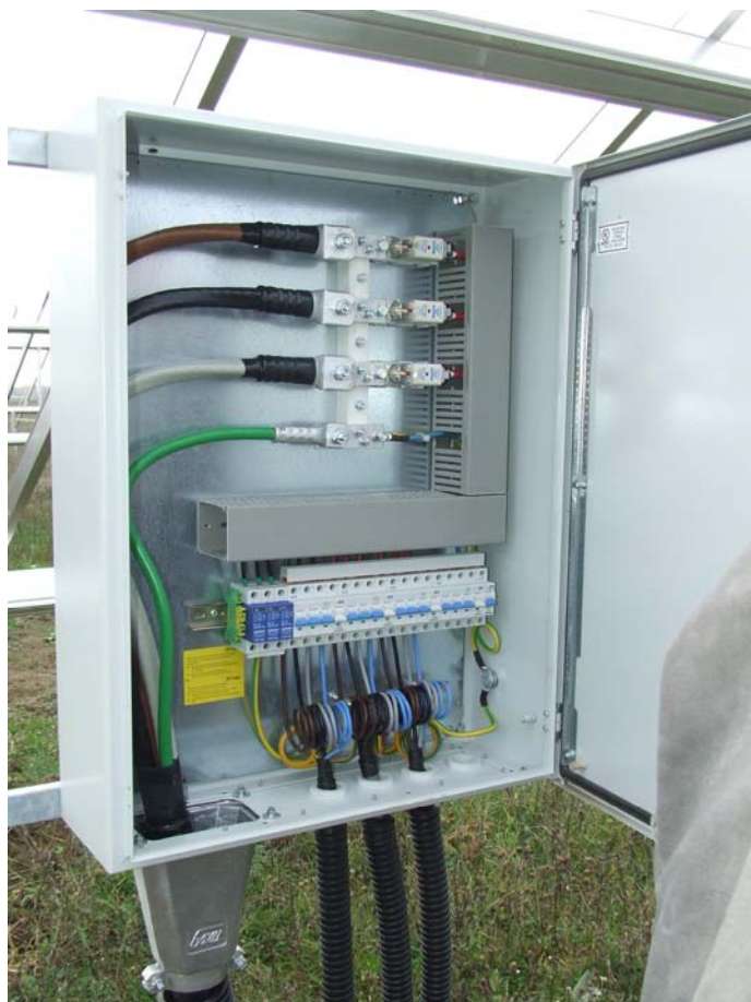
Fig.5.20. Cutia de conexiuni de la inverter
