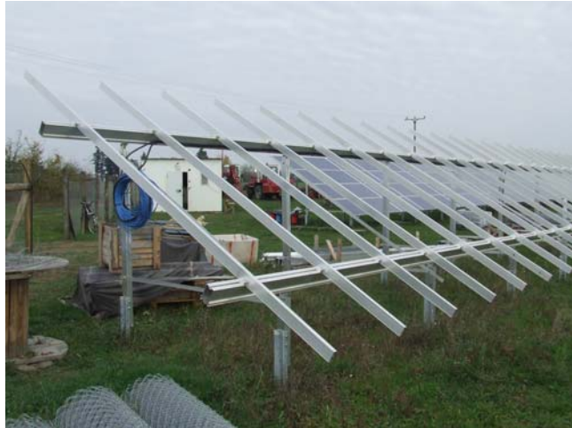
Fig.4.6. Structura fixă de susținere a panourilor fotovoltaice din cadrul centralei din Comuna Giroc
