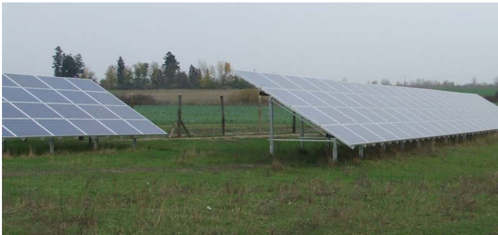
Fig.4.7. Rânduri de panouri fotovoltaice la centrala din Comuna Giroc
