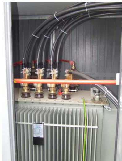
Fig.5.7. Transformatorul de 1250 kVA
