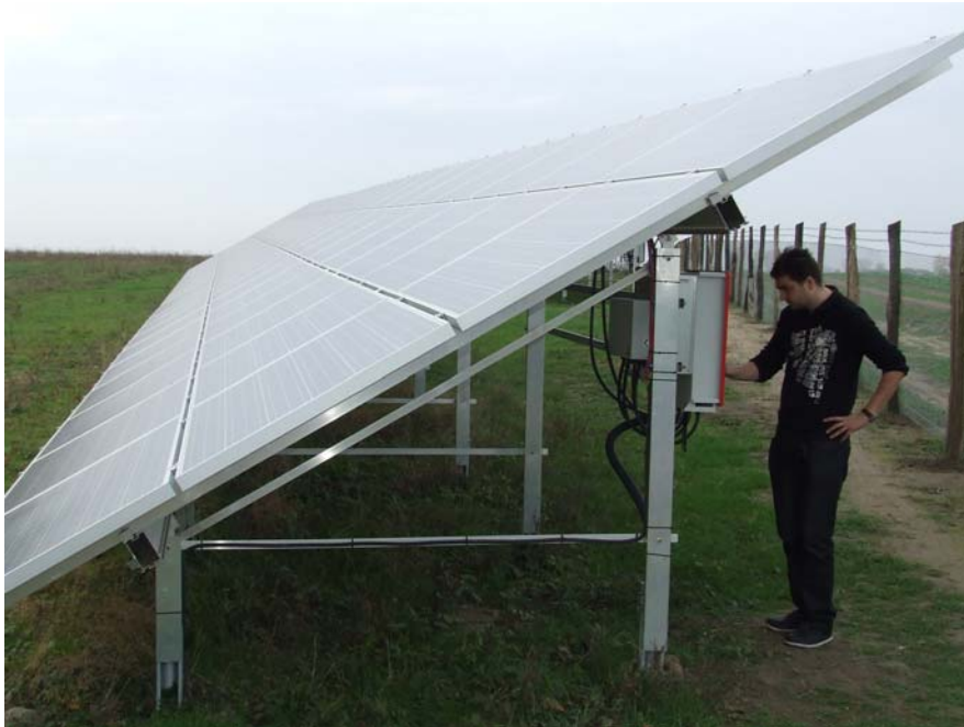
Fig.4.8. Bloc compact de panouri fotovoltaice de la centrala din Comuna Giroc
