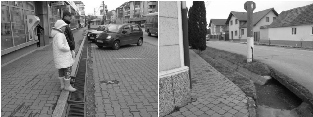
Figura 5.3. Canalizare pluvială Sebeș
