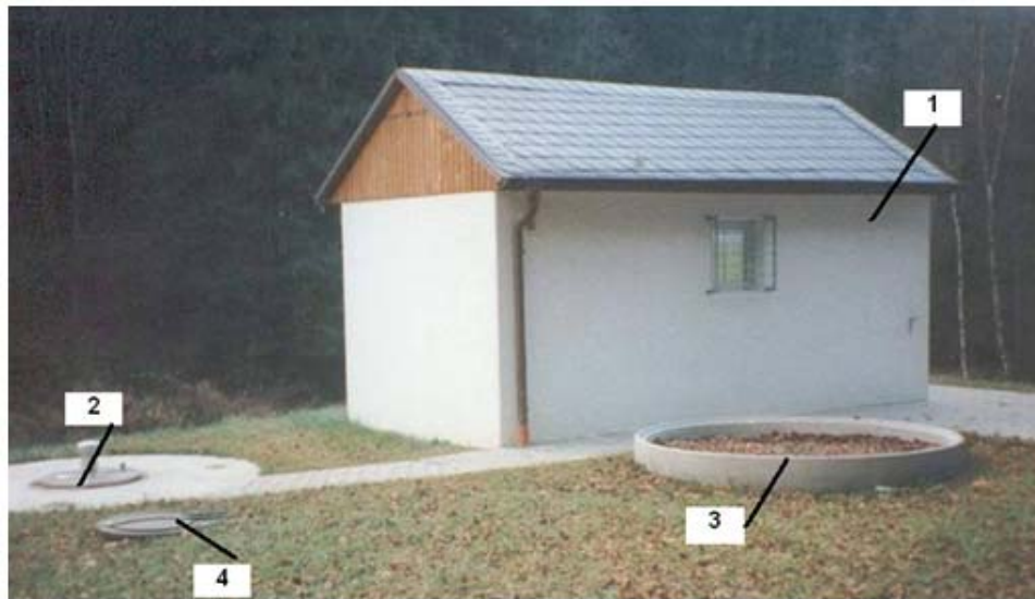
Fig. 2.9 Stația de generare a depresiunii (stația de vacuum) 1 - clădirea stației de vacuum; 2 - Rezervor de vacuum ingropat; 3 - biofiltrul de aer; 4 - camera de colectare condens rezultat din biofiltru
