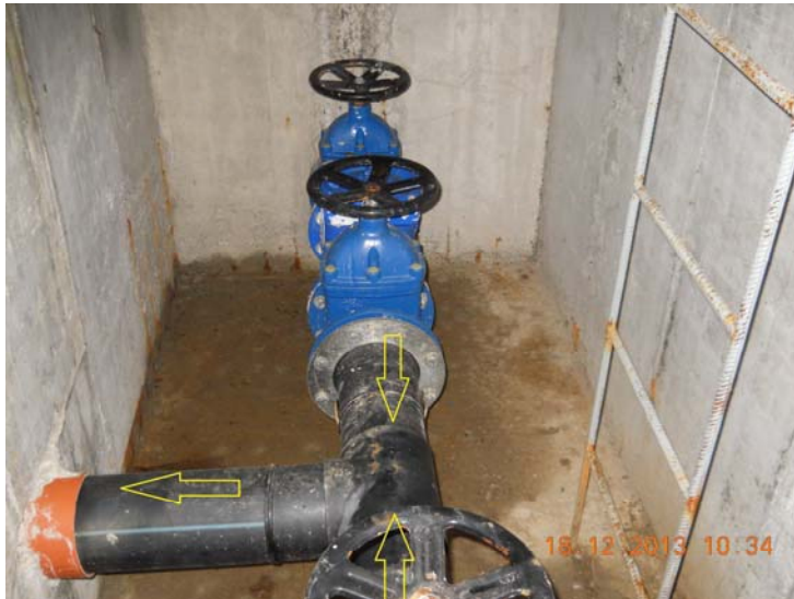
Racord conductă evacuare executat greșit
