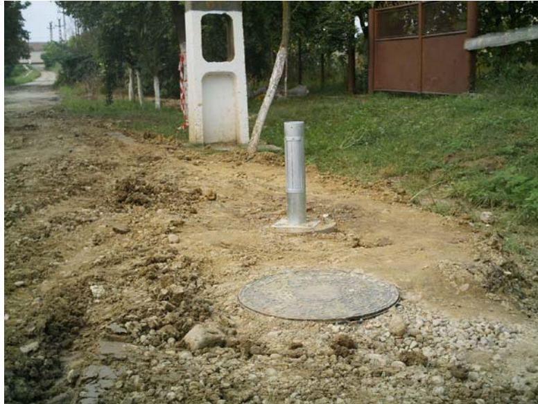
Fig. 5.14 Tub de aerisire instalat lângă căminul colector
