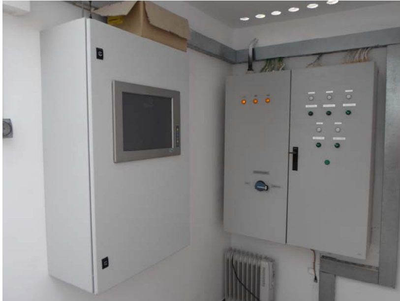
Fig. 4.27 Panoul electric de comandă și de control din stația de vacuum Pericei
