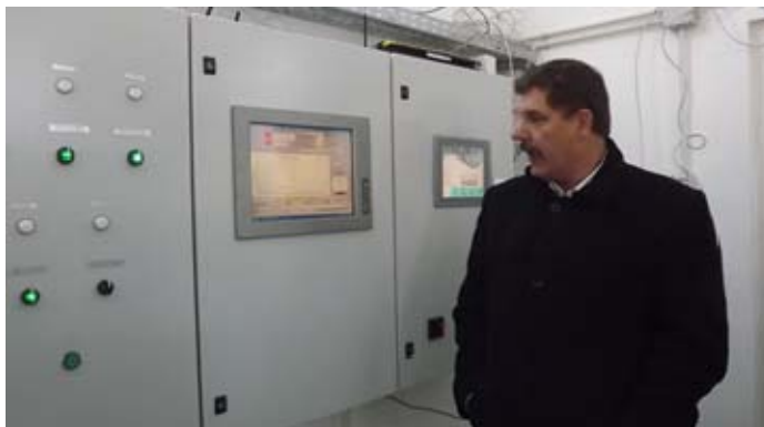
Fig.4.15 Panou automatizare a sistemului vacuumat de canalizare Borș
