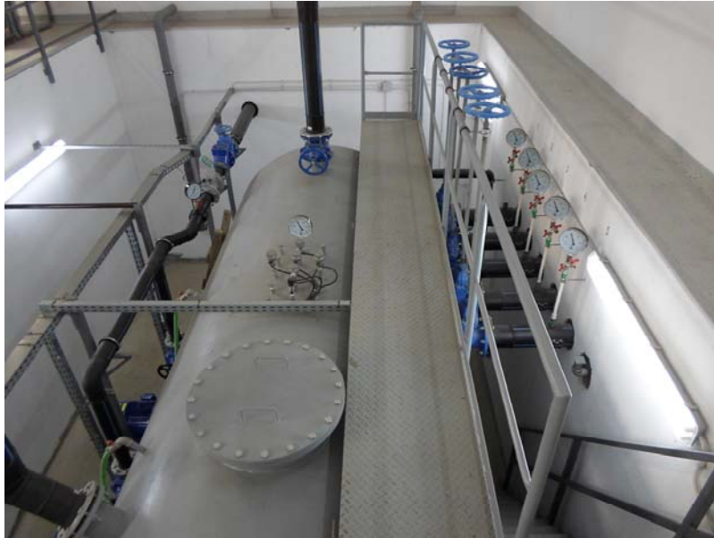
Fig. 4.13 Rezervorul de vacuum din cadrul stației de vacuum, localitatea Borș
