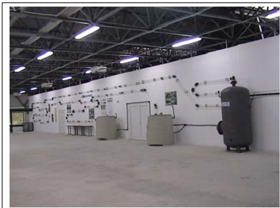
Fig. 4.1 Poligonul experimental pentru studiul și cercetarea sistemelor vacuumate de canalizare - Departamentul Hidrotehnica, Facultatea de Construcții, UPT
