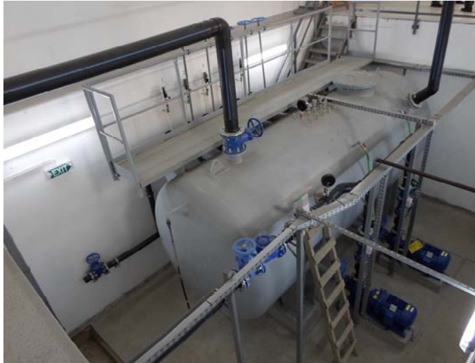
Fig.4.14 Pompele de evacuare apă uzată de la baza rezervorului - Borș
