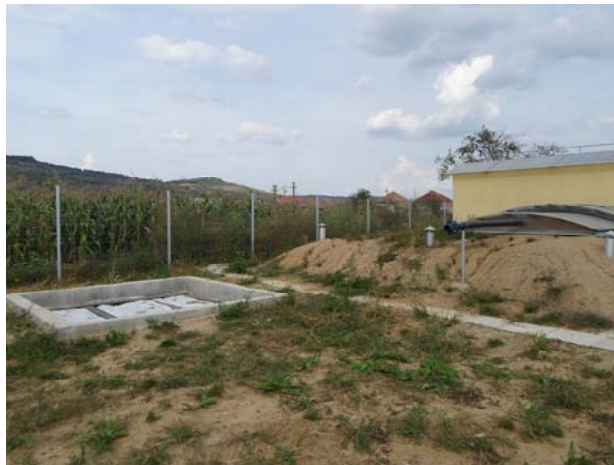
Fig. 4.29 Biofiltrul din cadrul stației de vacuum din Pericei
