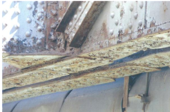
Figura 2.4.14. Coroziune puternică la talpa inferioară
