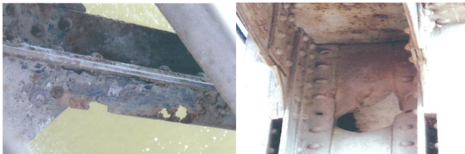
Figura 5.4.2.1. Coroziune puternică a contravântuirii și montantului
