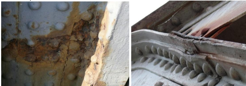
Figura 2.3.5. Elementele podului Traian de la Arad în stare avansată de coroziune
