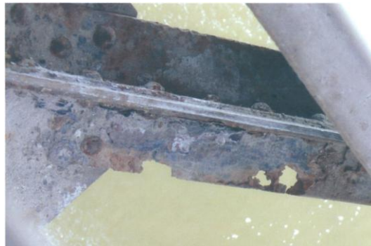
Figura 2.4.16. Contravântuire distrusă de coroziune
