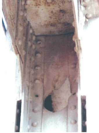
Figura 2.4.15. Coroziune puternică și ruptură la un montant
