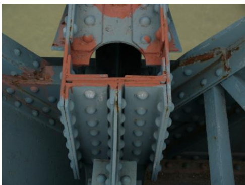
Figura 1.5.1.4.2. Coroziune la talpa inferioară
