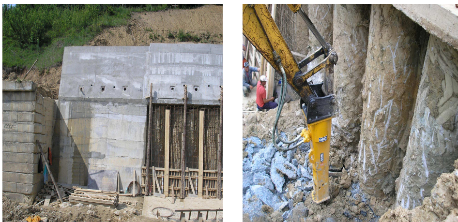
Fig.6.32 Coloane din b.a. solidarizate cu grinda din b.a. și ancore cu tiranți pretensionați
