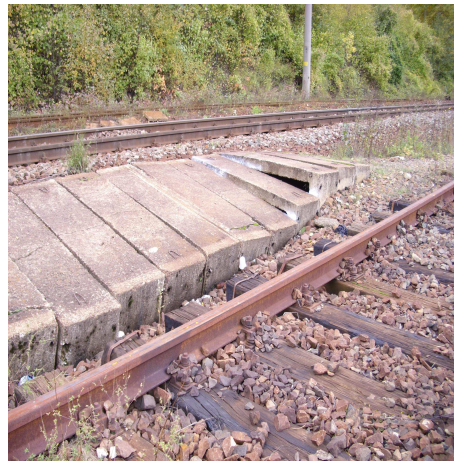
Fig.5.39 Peronul liniei 2 afectat de alunecare
