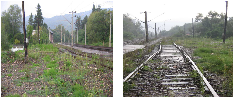
Fig.5.37 Denivelări pe capătul X al stației Merișor km.61+740 - 61+790
