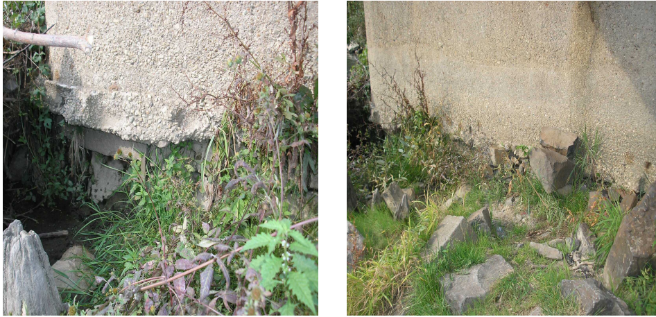
Fig.5.18 Fenomenul de afuiere a pilei podului km.456+276
