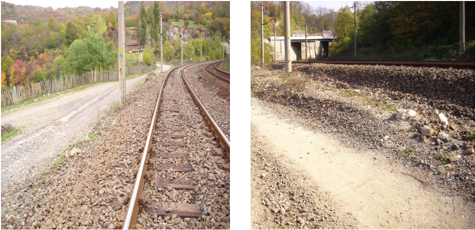
Fig.5.32 Instabilitate în corpul terasamentului km.58+150 - km.58+250 linia 116
