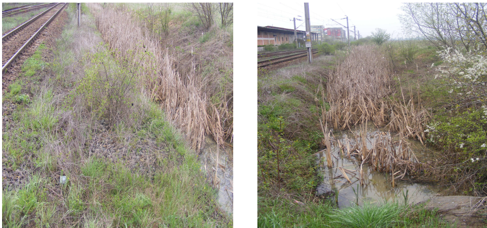
Fig.5.25 Podeț colmatat la capătul X stația Gurasada
