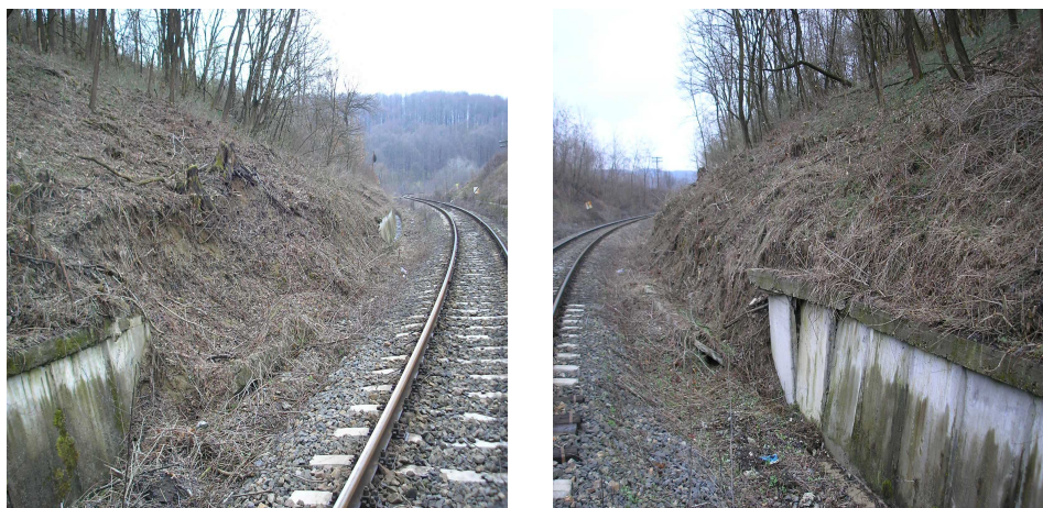
Fig.5.69 Zid de sprijin distrus în urma producerii unei alunecări de teren km.25+790 - km.26+000
