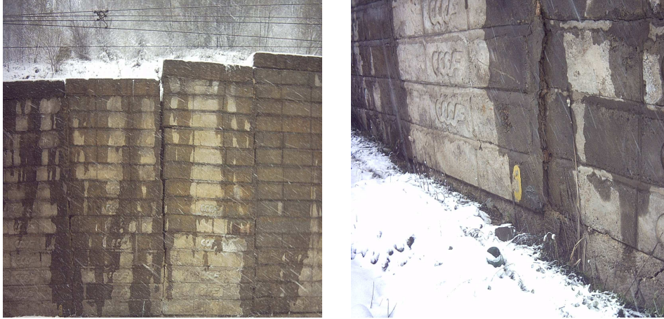
Fig. 6.29 Deplasarea fâșiiilor prefabricate și cedarea elevației
