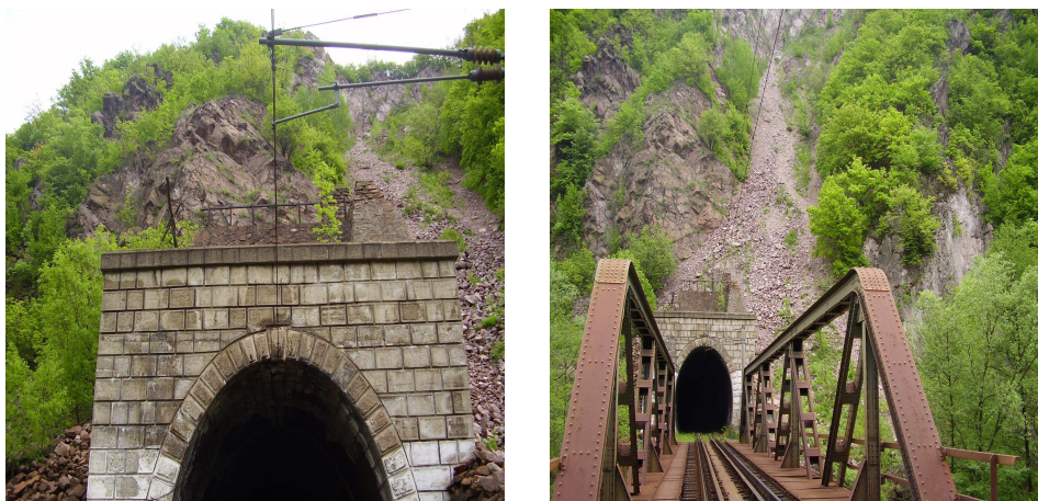
Fig.5.4 Căderi de stânci la portalul de ieșire din tunelul de la km.413+850 - km.414+850
