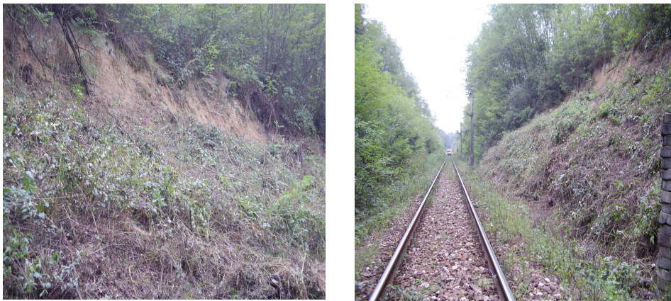
Fig.5.64 Alunecare taluz debleu linia Brebu - Reșița Nord km.24+300 - km.24+500
