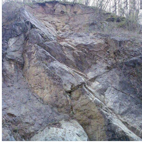
Fig.5.57 Crăpături în masivul de stâncă km.8+900 - km.9+100
