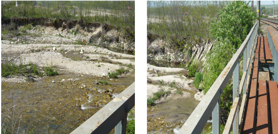
Fig.5.30 Fenomenul de eroziune a malului km.36+660 - km.36+685 linia 116
