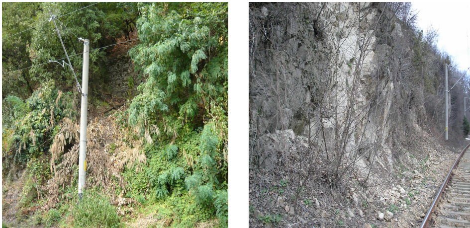
Fig.5.3 Căderi de stânci în linia 2 stația Băile Herculane km.405+070 - km.405+220
