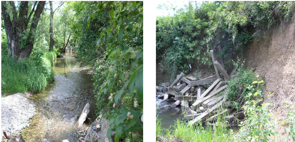
Fig.5.55 Eroziune mal - linia 130 Berzovia - Oravița km.70+700 - km.70+800
