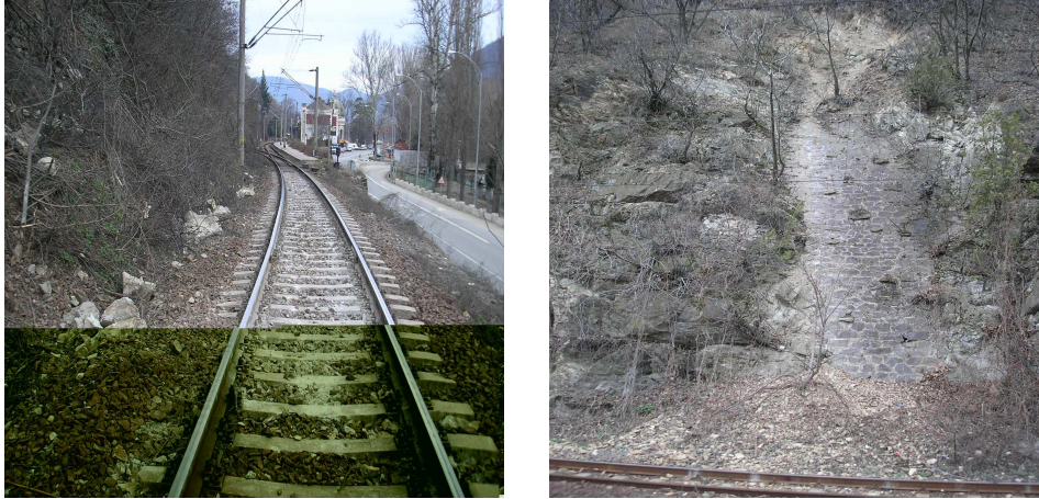
Fig.5.2 Căderi stânci în stația Băile Herculane capătul X km.404+950
