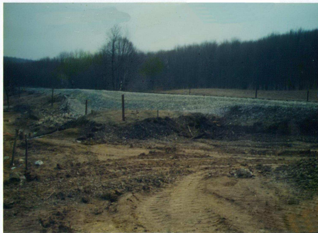
Fig.6.15. Linia de cale ferată Ilia - Lugoj km.25+350 .... km.25+500 înainte de închiderea totală a circulației
