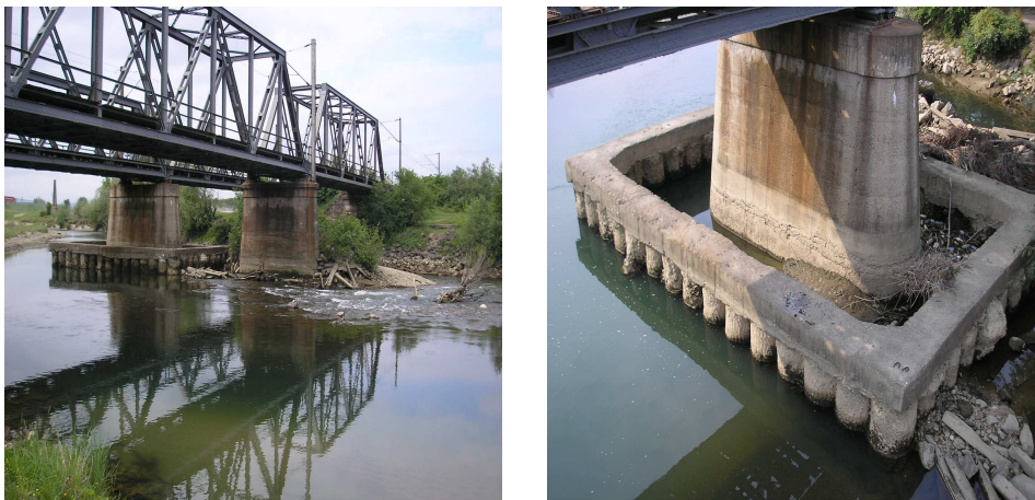
Fig.5.19 Pilă degradată la podul de la km.469+553 dintre stațiile Turdaș și Simeria linia 200
