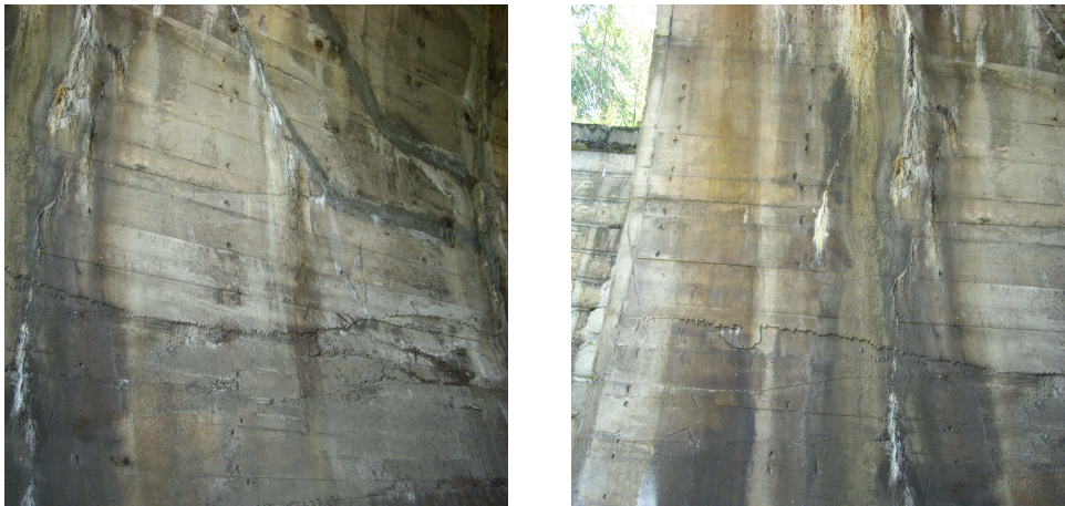
Fig.5.40 Fisuri și crăpături la portalul de intrare tunel km.63+315 - km.63+407
