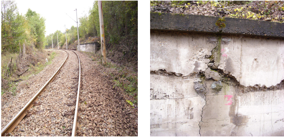
Fig.5.34 Crăpături în zidul de sprijin km.58+900 - km.59+100
