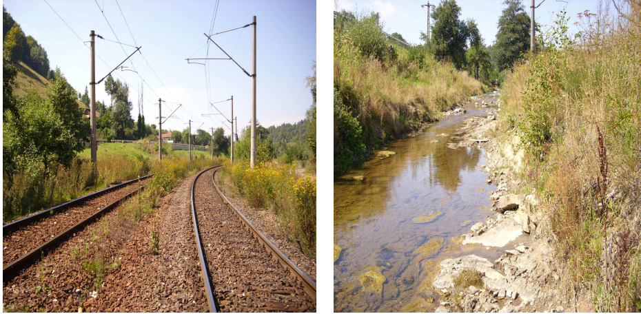
Fig.5.43 Eroziune mal linia 116 Simeria - Livezeni km.71+500 - km.71+800
