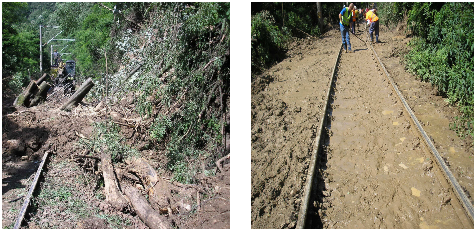
Fig.5.7 Terasament afectat de alunecarea versantului km.446+200 - km.446+350
