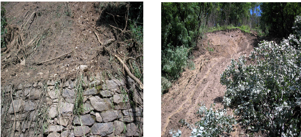
Fig.5.6 Alunecare versant între stațiile de cale ferată Teregova și Armeniș km.446+200 - km.446+350
