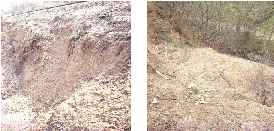
Fig.5.36 Alunecare în corpul terasamentului km.60+585 linia 116
