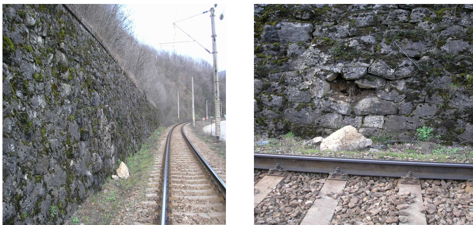
Fig.5.1. Zid de sprijin degradat pe linia de cale ferată Orșova - Băile Herculane km.392+400 - km.392+550
