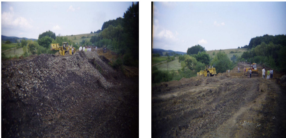
Fig.6.16. Strat de zgură negricioasă în corpul rambleului
