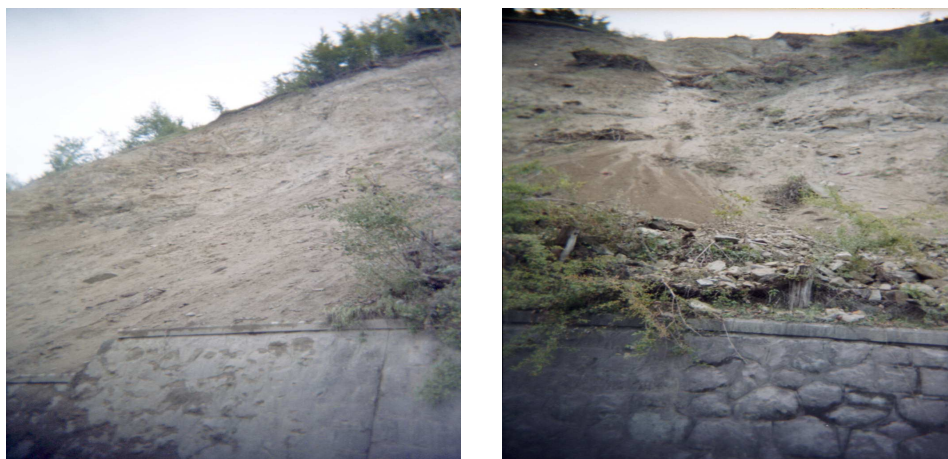
Fig.5.67 Făgașe produse pe taluz de ploile torențiale km.7+480 - km.7+640
