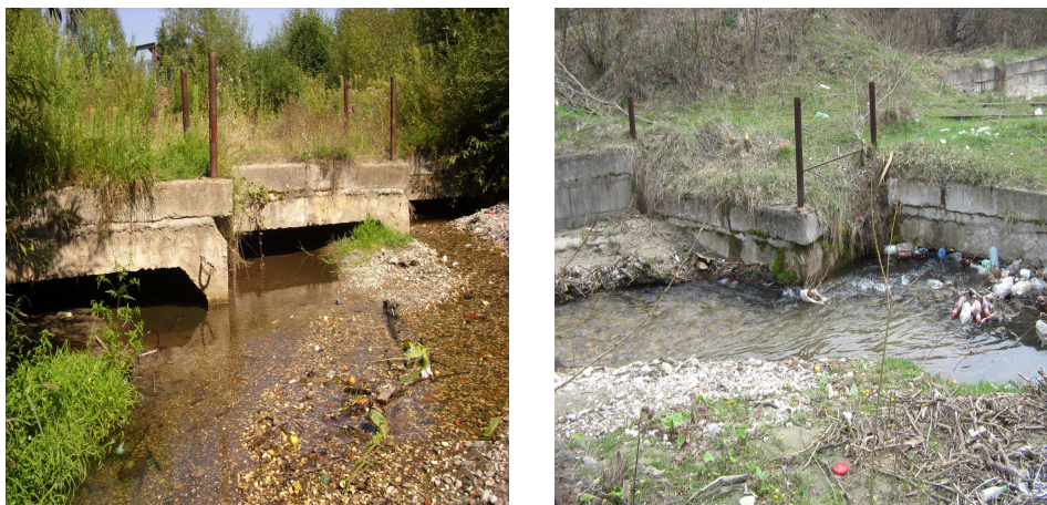
Fig.5.42 Podeț colmatat stația Bănița
