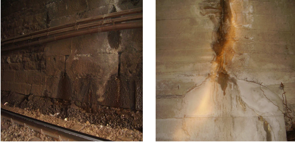
Fig.5.12 Tunel cu probleme tehnice între stațiile Teregova și Armeniș km.446+811 - km.447+080
