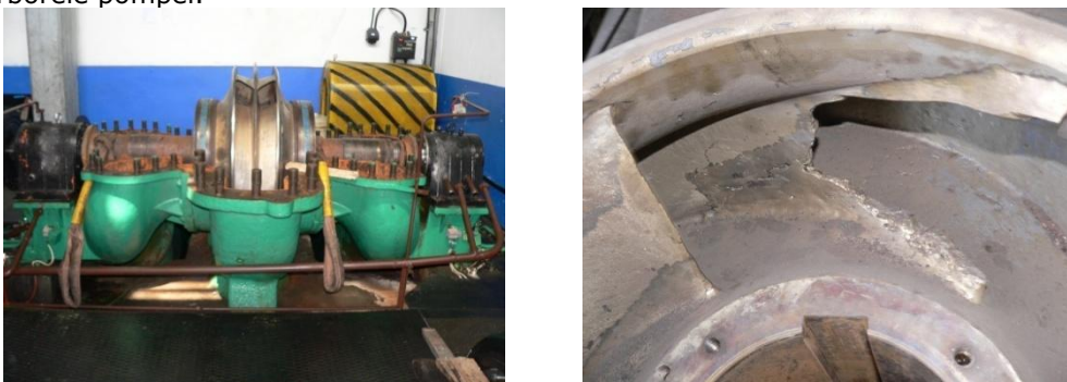
Fig. 3. 1 Pompa de acumulare din SP Jidoaia (stânga) și rotorul de pompă erodat (dreapta)
