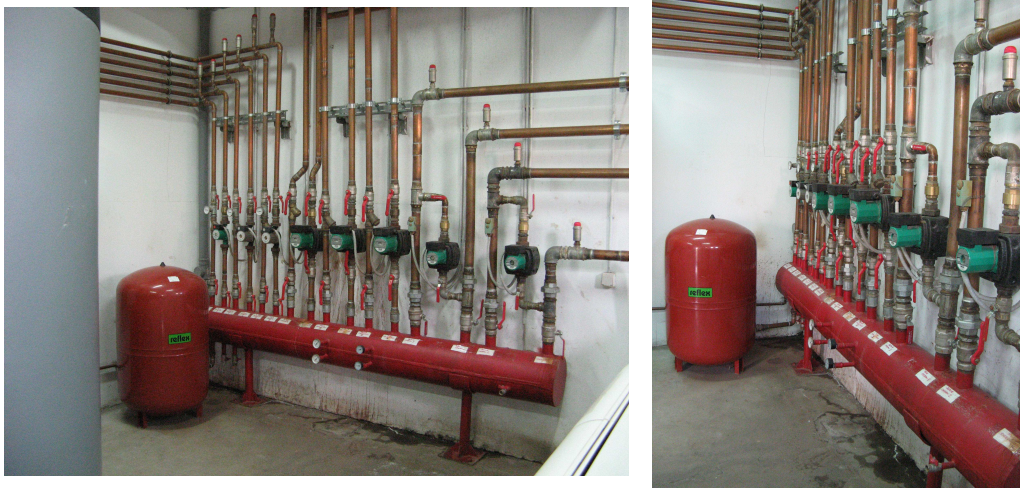
Fig. 13. Centrală termică echipată cu D-C monobloc cu diafragmă orizontală de separare, în montaj singular
