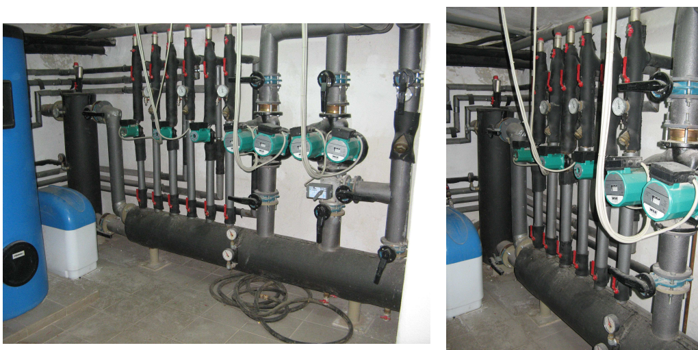
Fig. 15. Centrală termică echipată cu D-C monobloc cu diafragmă orizontală de separare cuplat cu butelie de egalizare a presiunilor
