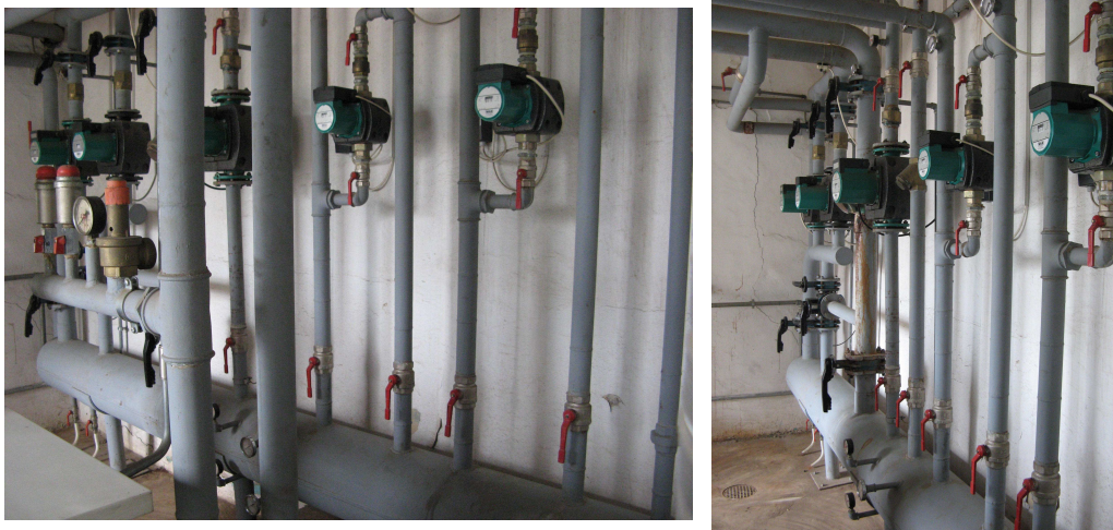
Fig. 14. Centrală termică echipată cu D-C monobloc cu diafragmă orizontală de separare, în montaj singular
