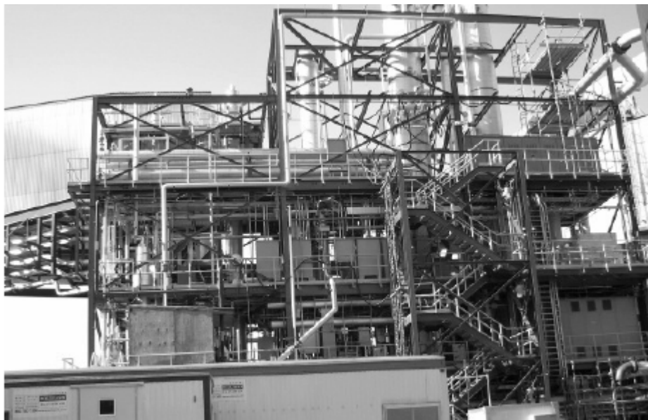
Figura 3.8. Instalațiile pilot industrial la centrala electrică Pleasant Prairie, We Energy
