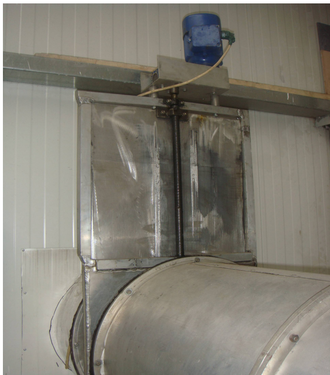
Fig.6.5. Motor-reductor pentru reglarea debitului de aer
