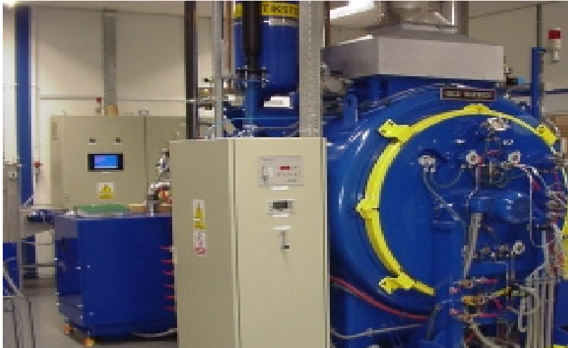
Fig.5.5. Instalație de brazare în vid
