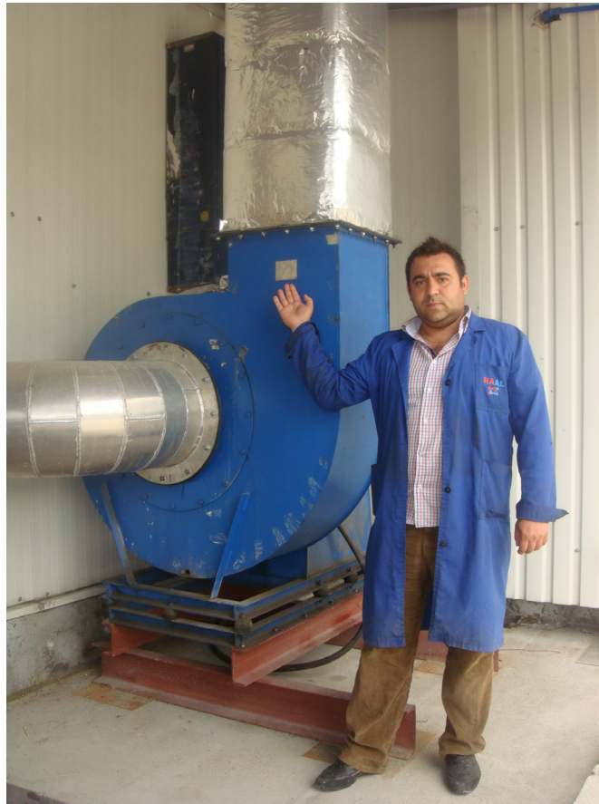
Fig.6.4. Ventilatorul de aer cu motor electric de 55kW
