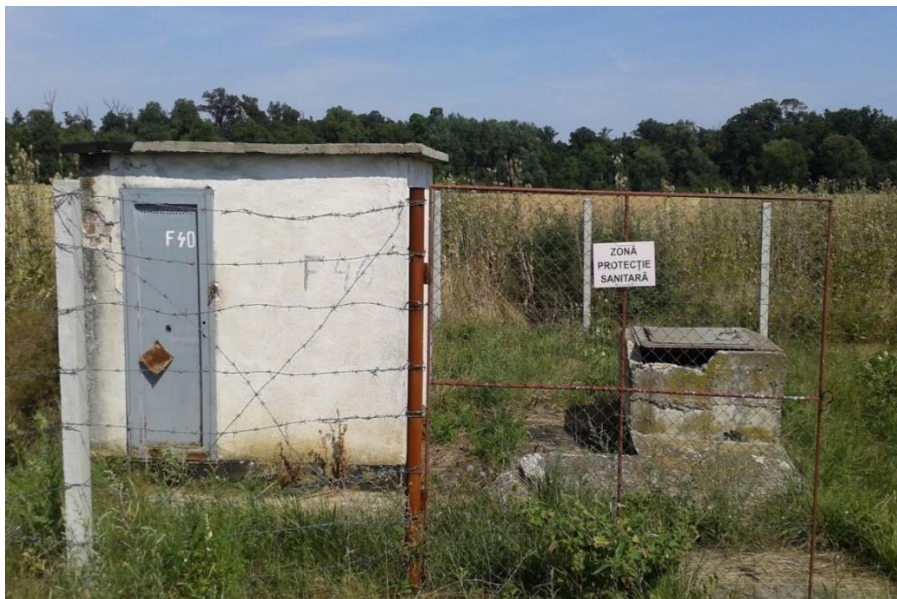
Fig.6.1. Foraj 40 aferent frontului de captare STA Urseni
