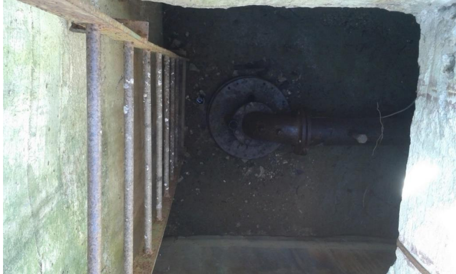
Fig.6.2. Foraj 40 aferent frontului de captare STA Urseni
