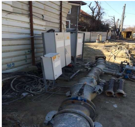
Figura 4.25. Tablou sistem de alarmă, tablouri electrice secundare
