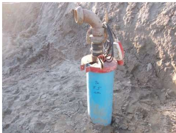
Figura 4.33. Echiparea cu pompe
