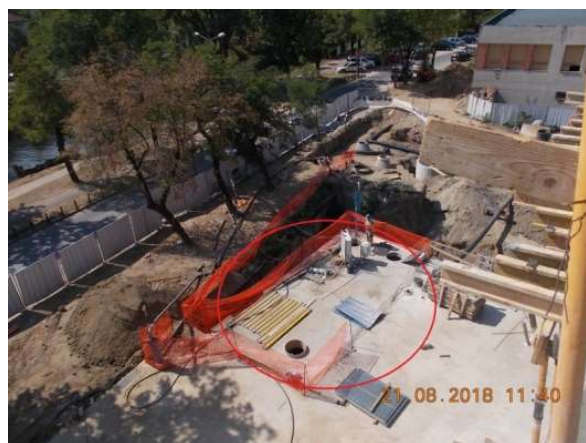
Figura 8.17. Stația de pompe alipită clădirii A
