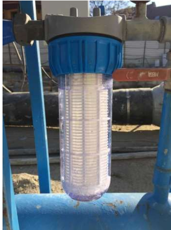
Figura 4.22. Filtrul de reținere a particulelor de nisip
