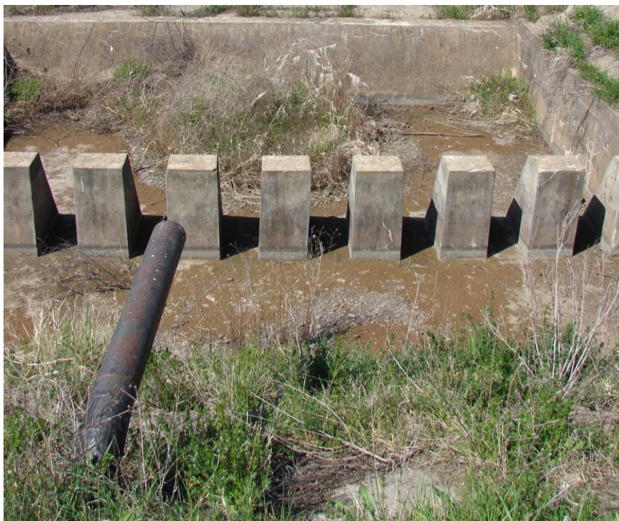
Foto 2.13 Bazin de refulare SP Repompare Fântânele (foto Gabor A. – 2011)
