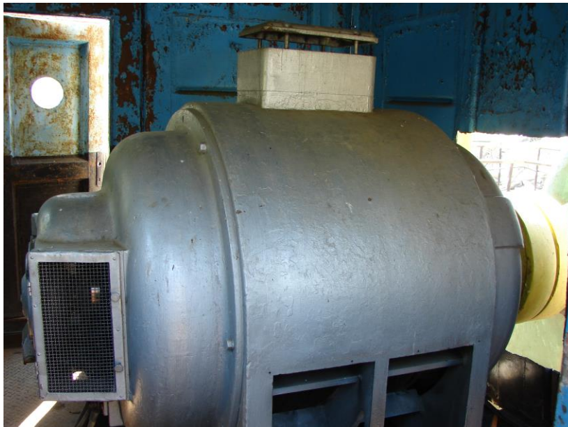
Foto 2.7 SP Plutitoare Fântânele ELECTROMOTOR 630KW agregat de pompare nr.1 (foto Gabor A. - 2011)
