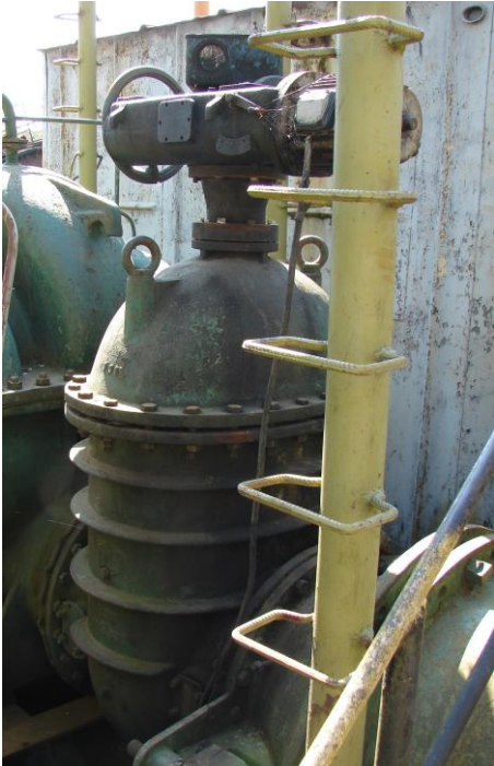
Foto 2.5 SP Plutitoare Fântânele vana agregatului de pompare nr.1 (foto Gabor A. - 2011)
