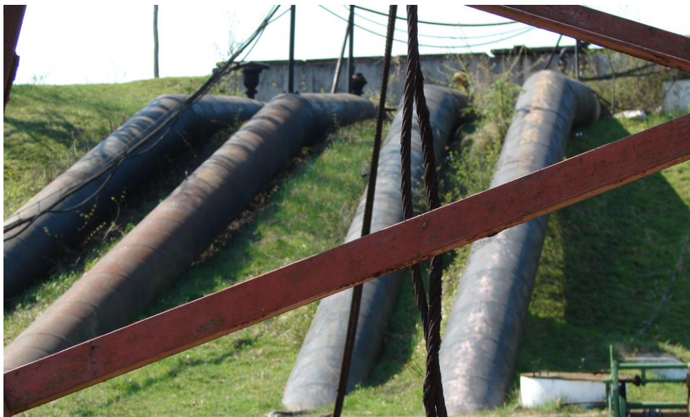
Foto 2.8 SP Plutitoare Fântânele conducte refulare Dn 1000 (foto Gabor A. – 2011)
