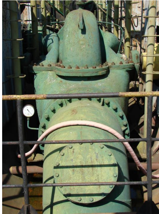
Foto 2.6 SP Plutitoare Fântânele pompa SIRET 900 agregat de pompare nr.1 (foto Gabor A. - 2011)
