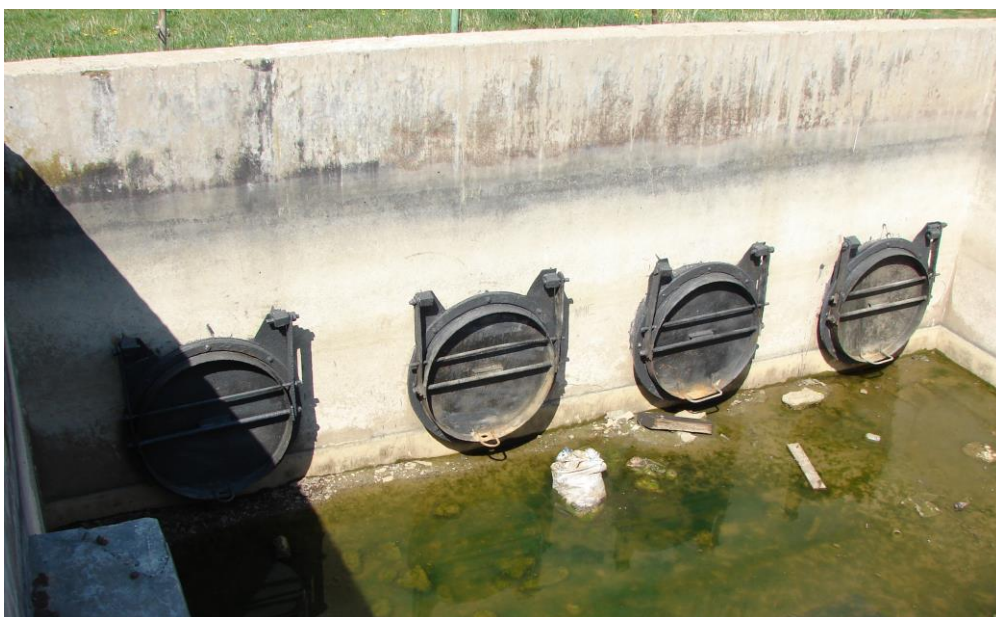
Foto 2.9 Bazin de refulare SP Plutitoare (clapeți) (foto Gabor A. – 2011)
