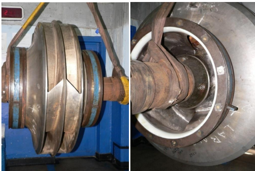
Fig. 3. 1 Rotorul pompei centrifuge existent la SP Jidoaia.
