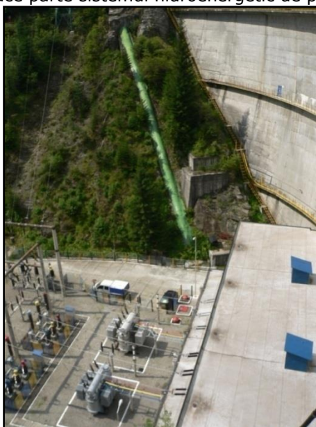
Fig. 1. 15 Vedere generală a stației de pompare Jidoaia
