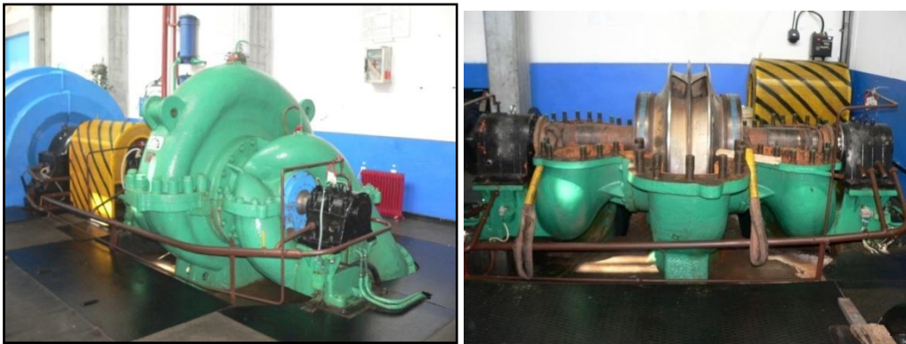
Fig. 1. 17 Vedere hidroagregat PRO 10-195 – pompa din SP Jidoaia
