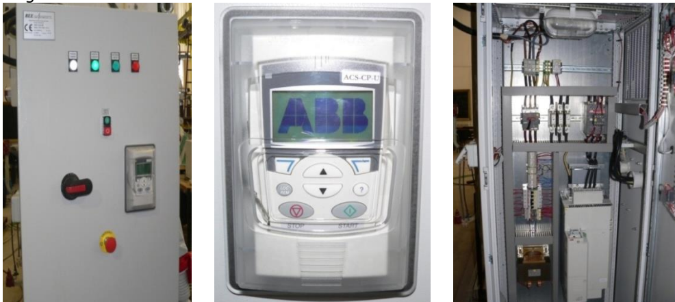
Fig. 2. 16 Invertorul ACS850 în laboratorul de pompe: panoul frontal la pornire (stânga) și panoului de comandă (mijloc), interiorul panoului de comandă (dreapta)
