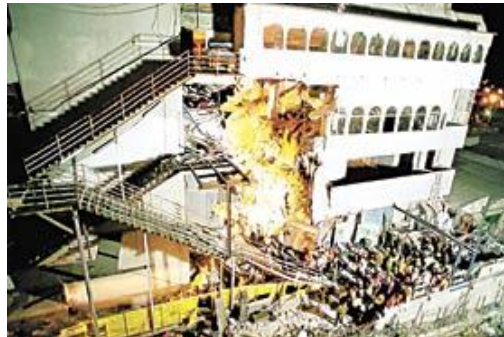
Fig.4.8. Colapsul sălii de evenimente din Ierusalim
