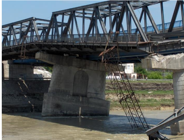
Fig.3.19. Podul de la Mărăcineni cu pilele în plin proces de afuiere înainte de prăbușire
