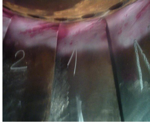
Fig. 1.22 Fisuri palete rotor turbină [35].
