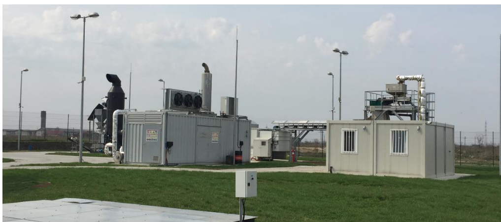
Fig.23. Unitate de cogenerare de la stația de biogaz Seini
