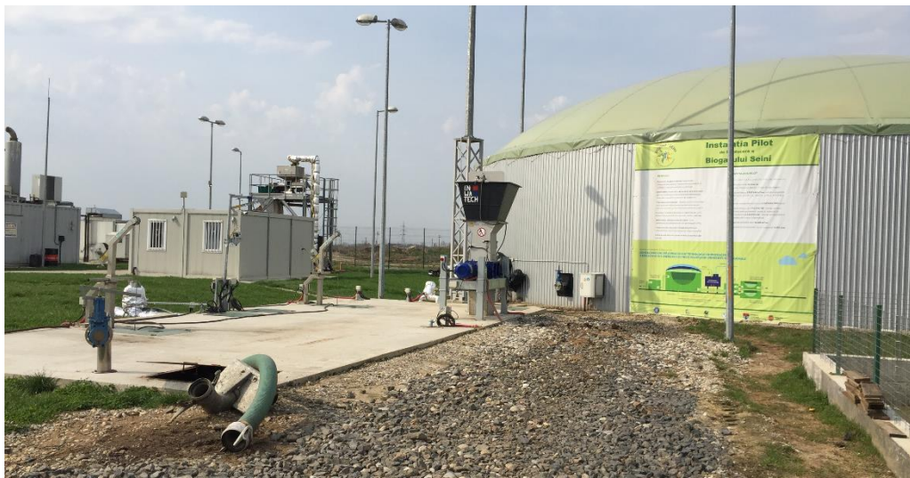
Fig.22. Bioreactorul de la stația de biogaz Seini
