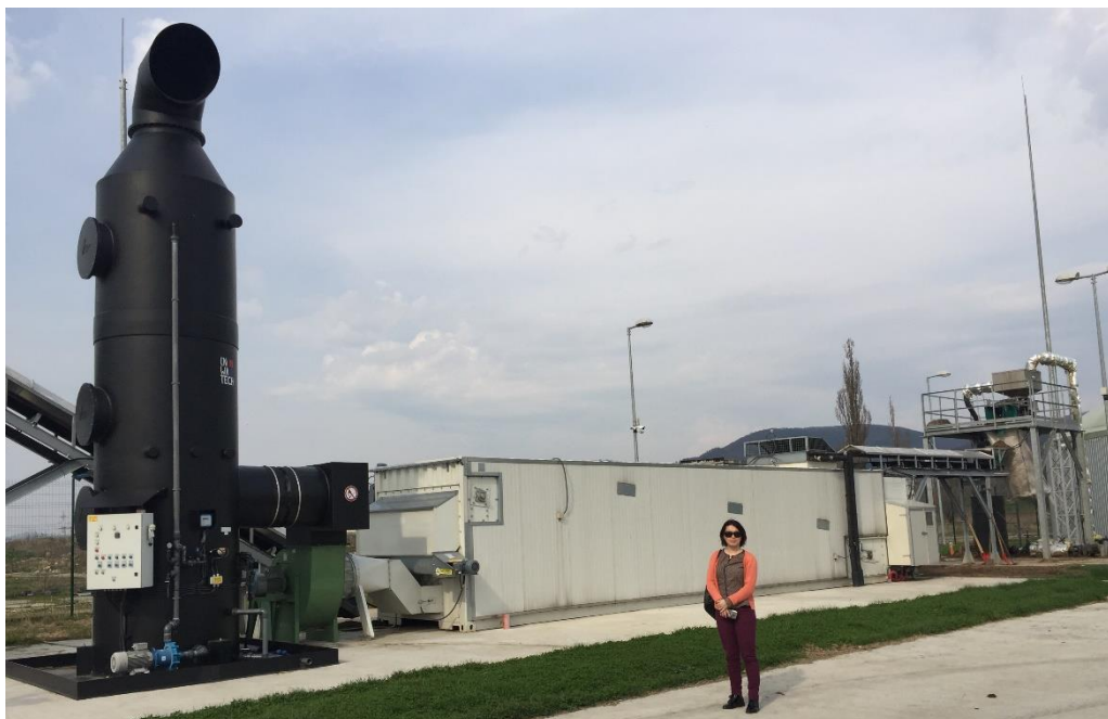
Fig.24. Linia de producere fertilizator de la stația de biogaz Seini
