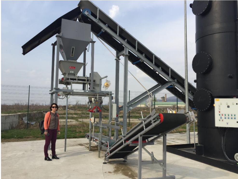
Fig.25. Instalația de ambalare fertilizator de la stația de biogaz Seini
