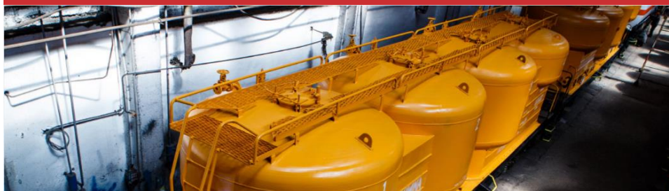
Servicii spălare vagoane cisternă la interior
