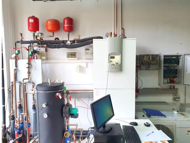
Fig. 1.9 Exemplu de pompă de căldură
