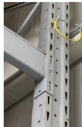
c. Exemplu de conectare raft metalic în zona de magazie la instalația de echipotețializare
