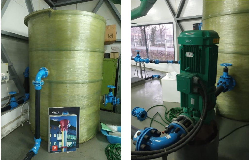
Figura 36. Rezervorul de apă și pompa de ridicare presiune
