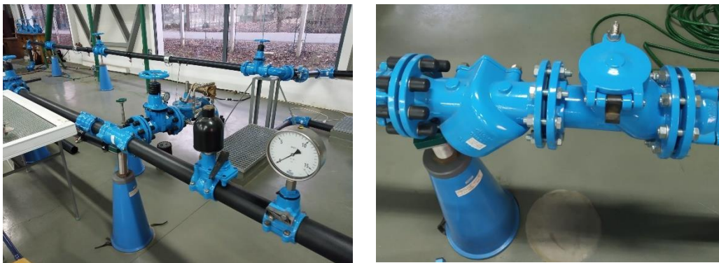
Figura 37. Clapeta de sens, filtrul Y, manometrul și ramificația pentru by-pass
