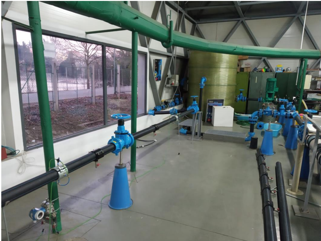
Figura 35. Vedere în ansamblu a instalației de testare
