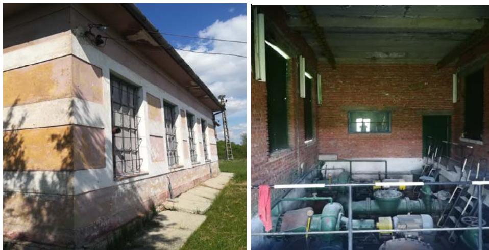
Figura 5.36. Stația de pompare Cărăstău
