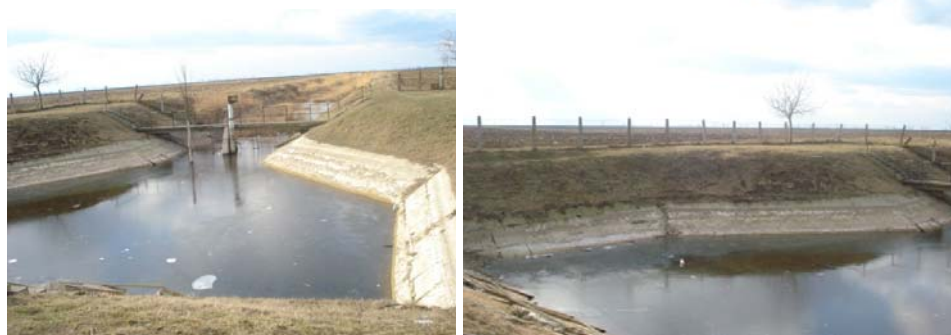
Figura 5.81. Bazinul de aspirație de la stația de prepompare Grabați
