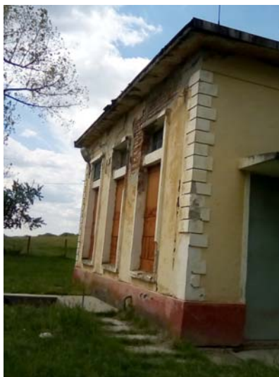
Figura 5.134. Stația de pompare Partoș II
