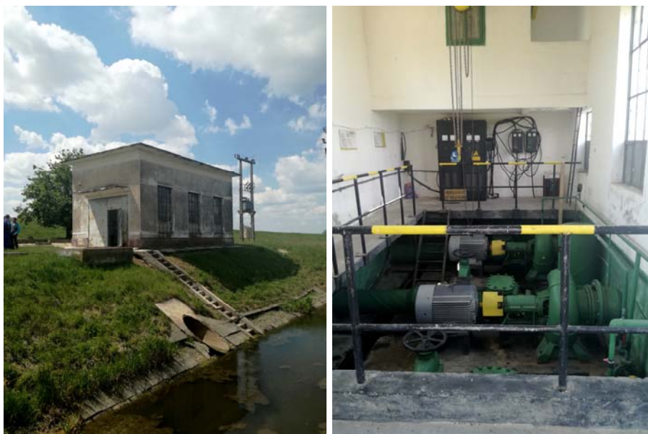
Figura 5.127. Stația de pompare Ghilad I
