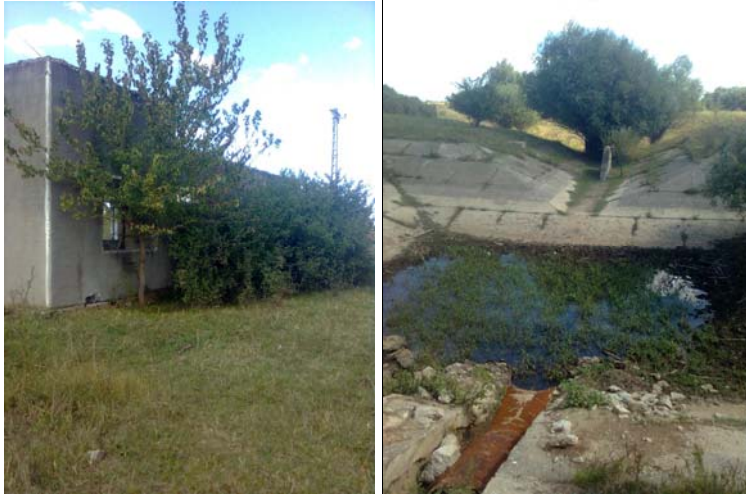
Figura 5.121. Stația de pompare Berecuța
