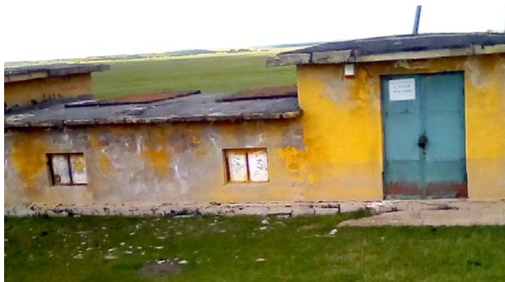
Figura 5.45. Stația de pompare Gai
