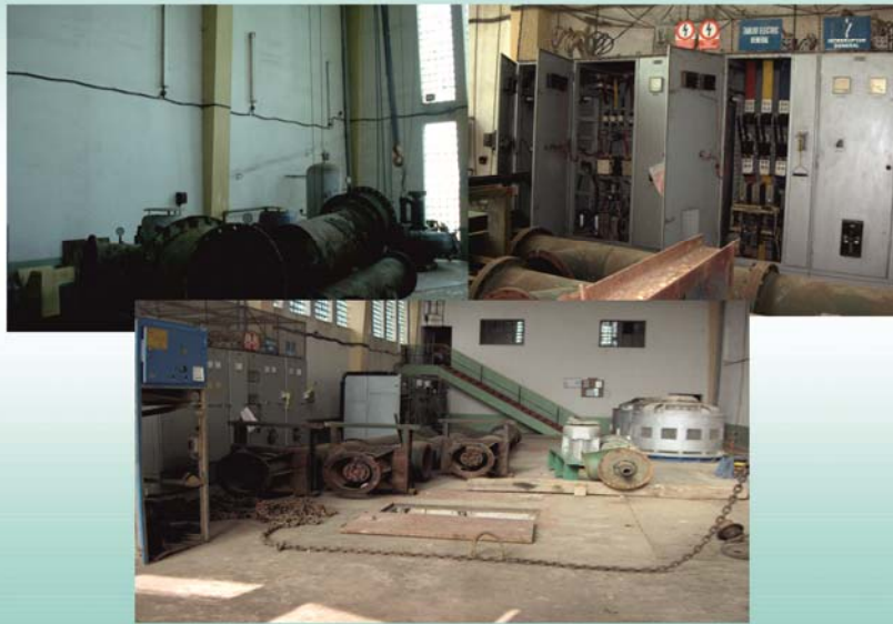
Figura 7.15. Instalatiile interioare și exterioare SP CENEI II
