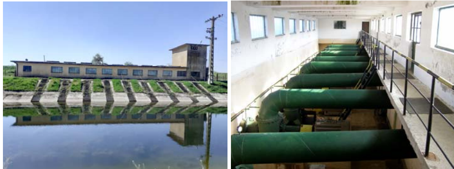
Figura 5.118. Stația de pompare Banloc
