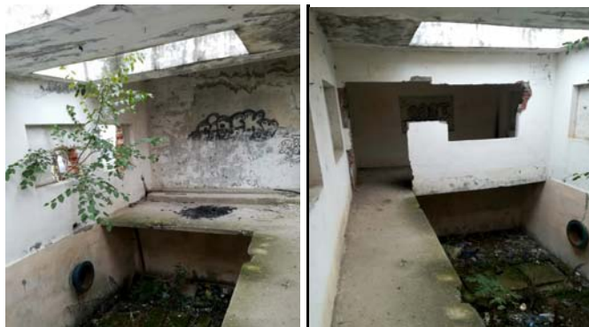
Figura 5.120. Stația de pompare Breștea
