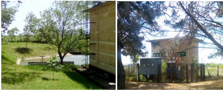
Figura 5.52 Stație pompare Ciavoș
