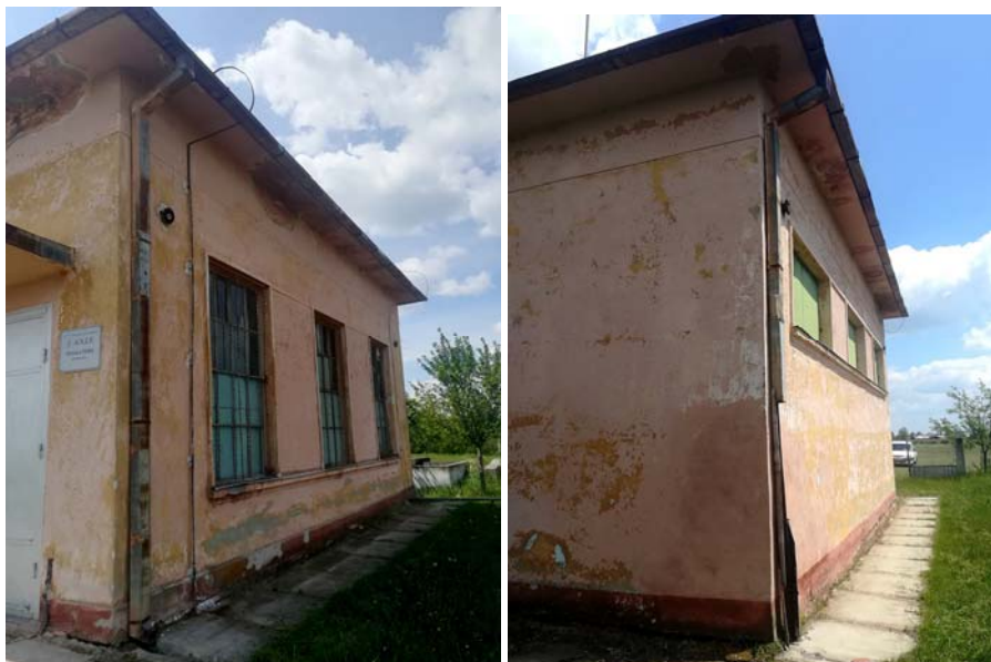
Figura 5.59. Stația de pompare Şurgani II
