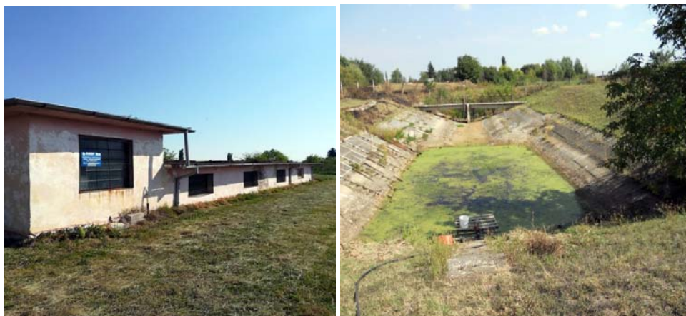
Figura 5.23. Stația de pompare Sânmihaiu Român
