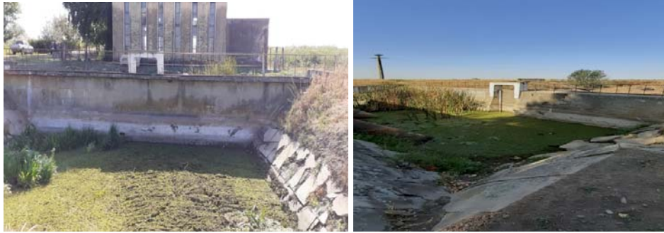
Figura 5.90. Stația de pompare Keriteș I
