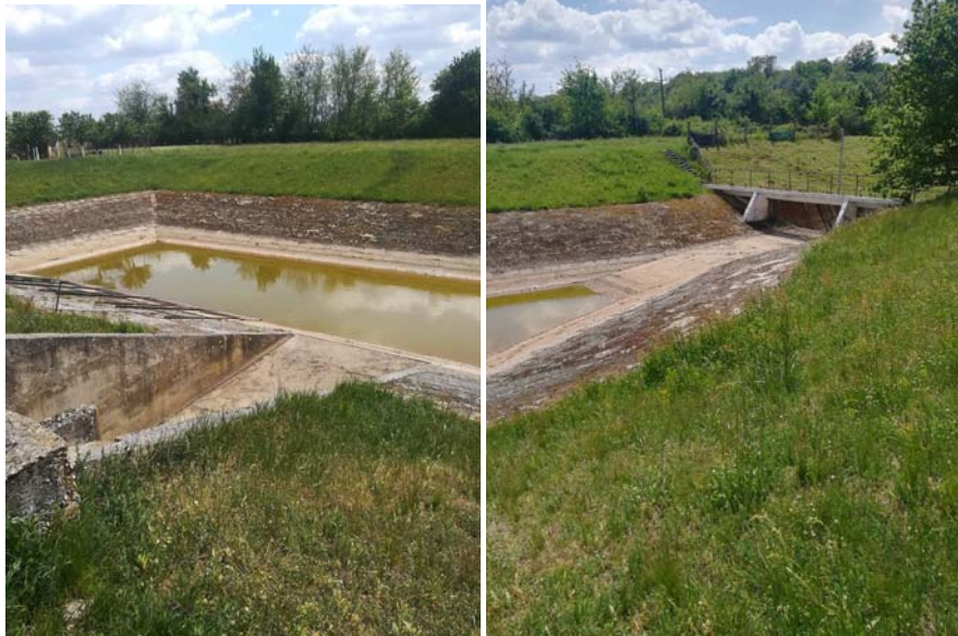
Figura 5.40. Bazinul de aspirație și de refulare de la Stația de pompare Sârbova
