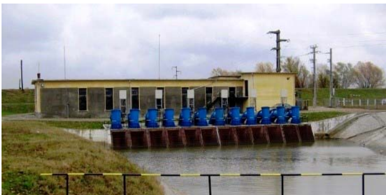
Figura 7.7. Stația de pompare Cruceni
