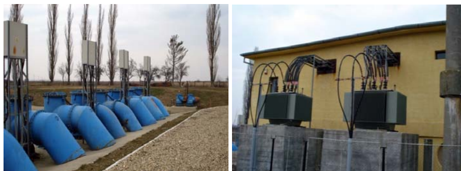
Figura 5.26. Stația de pompare Cruceni
