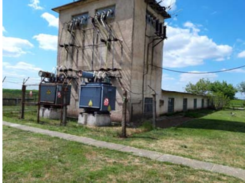
Figura 5.114. Stația de pompare Sânnicolau
