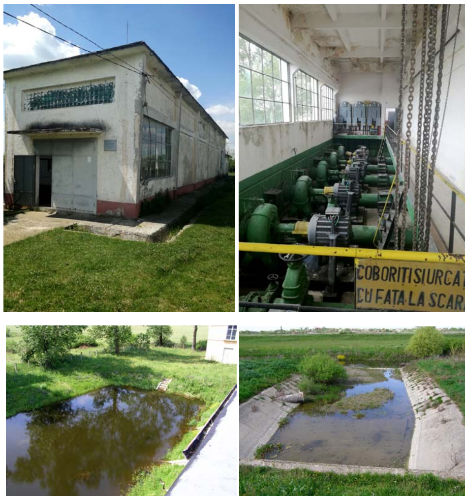
Figura 5.129. Stația de pompare Ghilad III
