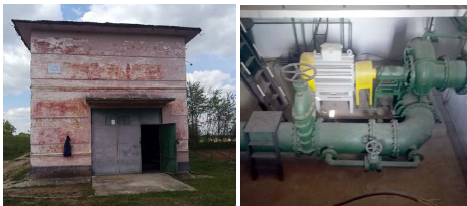
Figura 5.38. Stația de pompare Racovița
