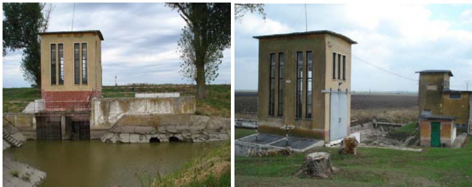
Figura 5.88. Stația de pompare Uivar
