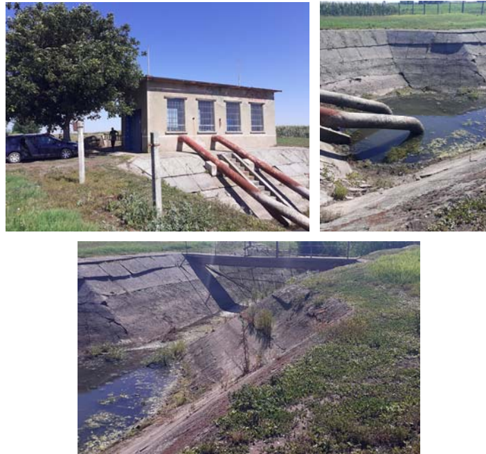
Figura 5.6. Stația de pompare Galațca
