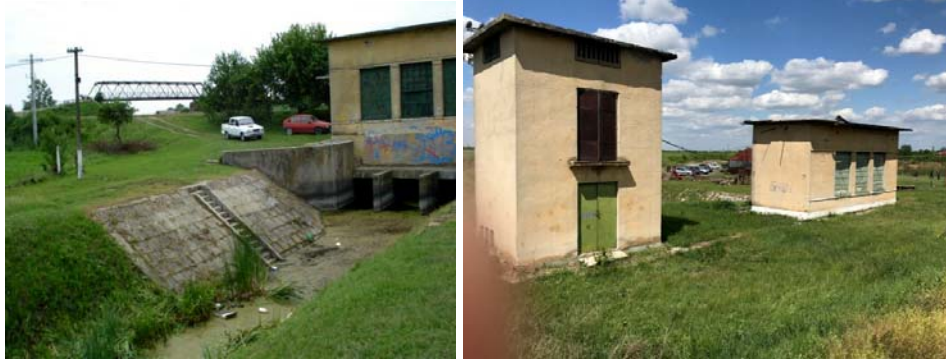
Figura 5.74. Stația de pompare Utvin
