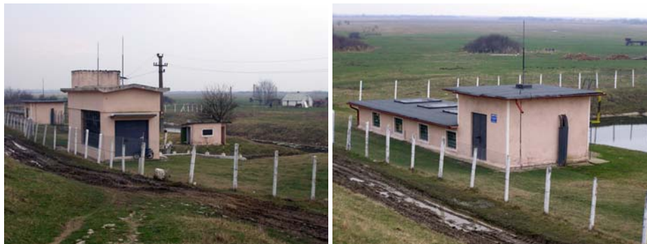
Figura 5.33. Stația de pompare Caraci I - II
