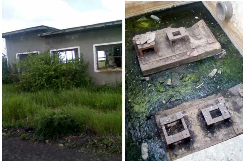
Figura 5.125. Stația de pompare Livezile Drenaj
