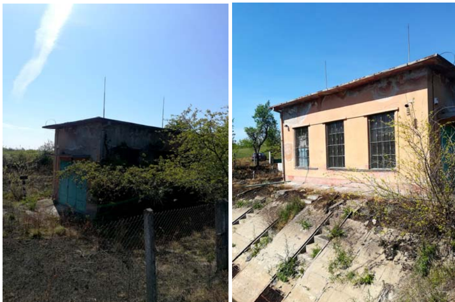
Figura 5.58. Stația de pompare Șurgani I
