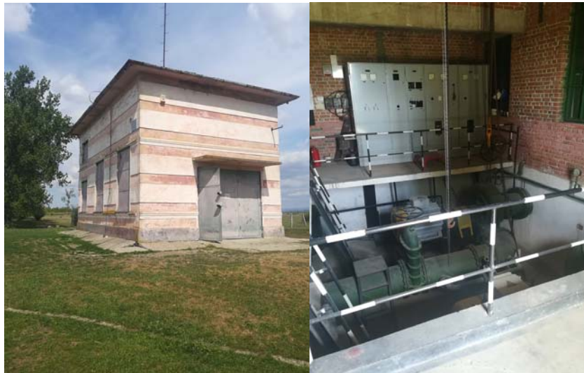
Figura 5.35. Stația de pompare Căpăt
