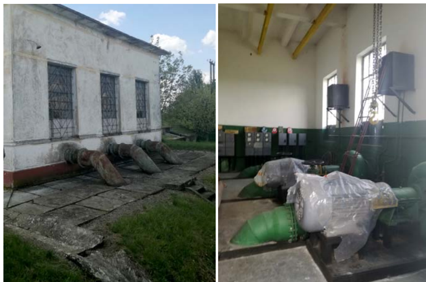
Figura 5.128. Stația de pompare Ghilad II
