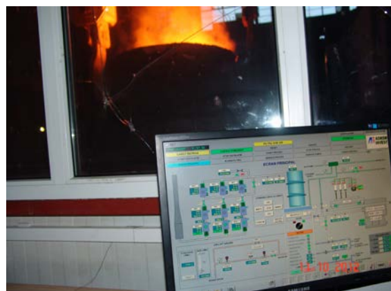
Fig. 2.7. Instalație de vidare, conducere automată [53].
