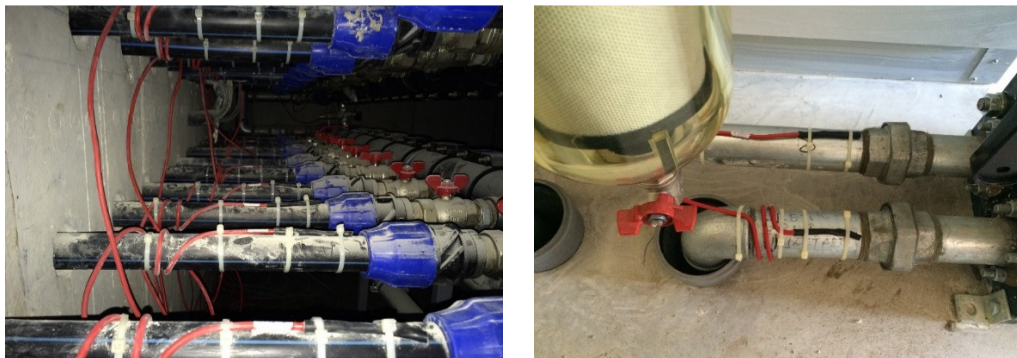
Figura 5.41 - Senzori foraje pompe de căldură și schimbător de căldură
