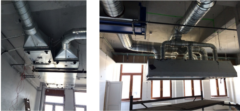
Figura 3.44 - Centrală de tratare a aerului și hotă bucătărie
