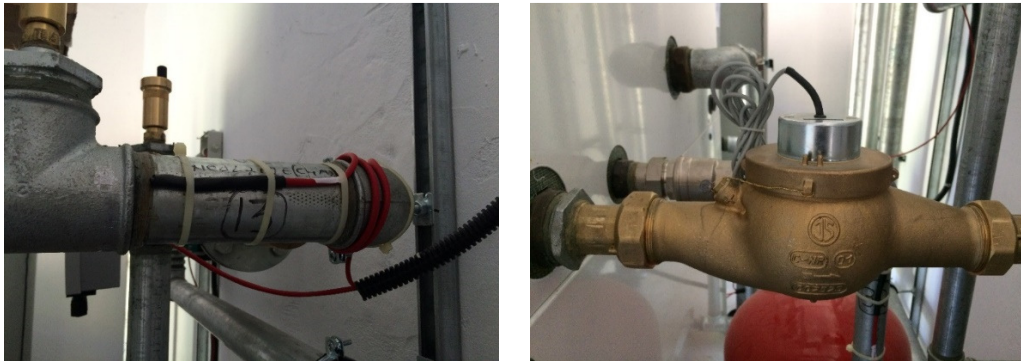
Figura 5.39 - Senzori de temperatură și debitmetru pompă de căldură
