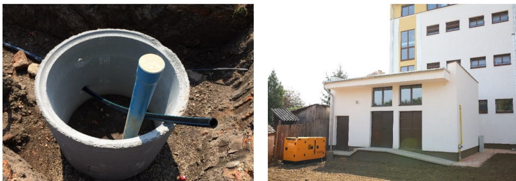
Figura 3.39 - Cămin foraj și centrală termică
