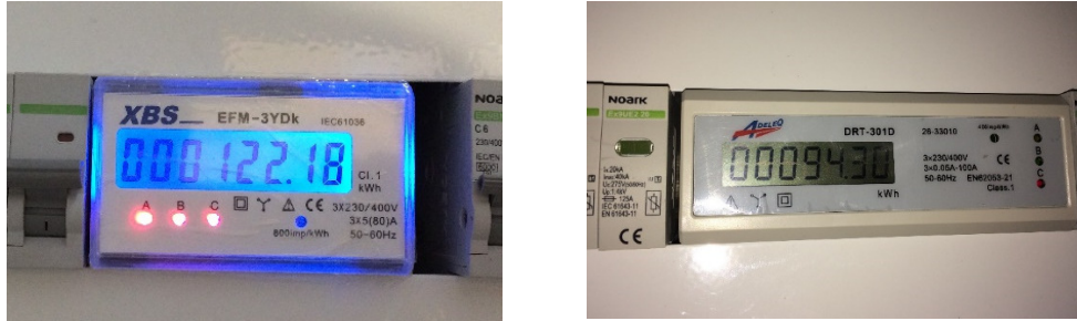
Figura 5.46 - Contoare consum energie electrică
