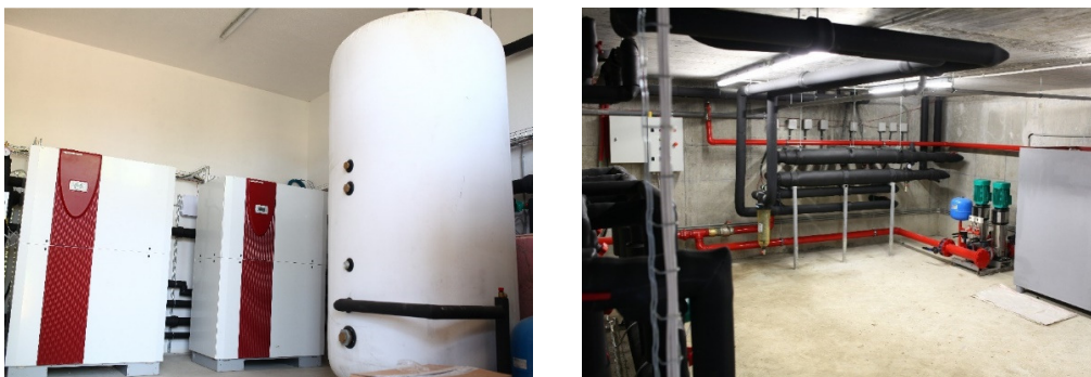
Figura 3.40 - Pompe de căldură și distribuitor foraje
