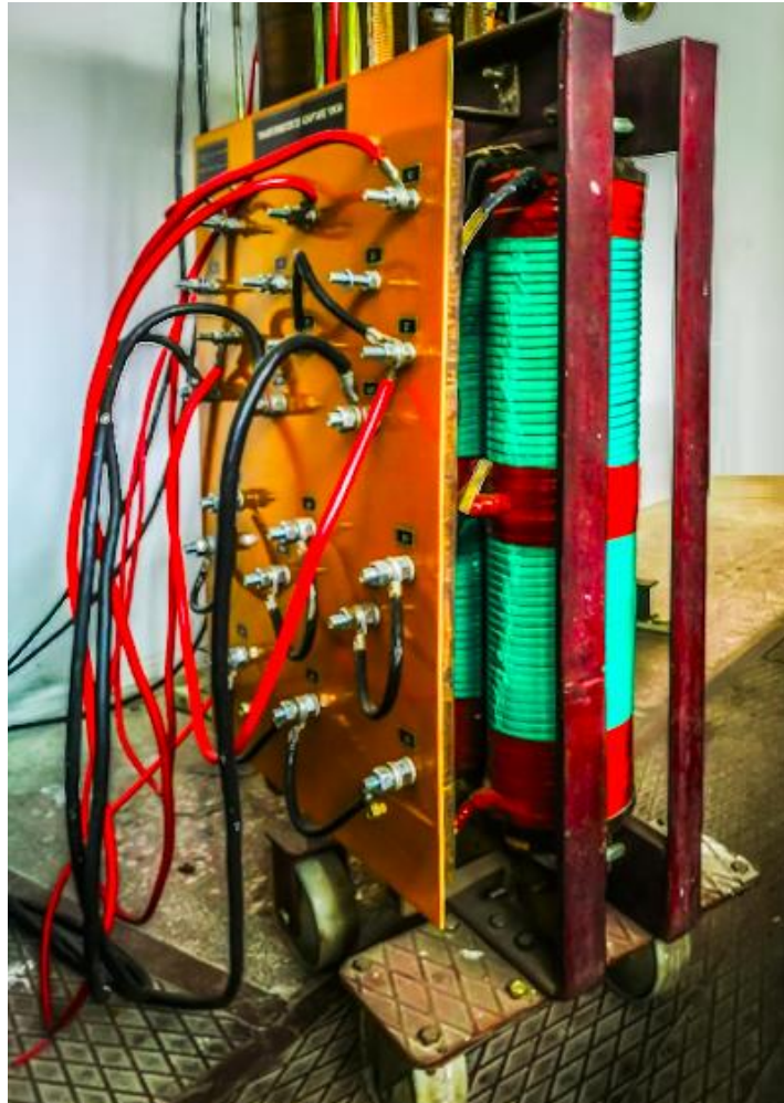
Fig. 5.3. Transformatorul de adaptare
