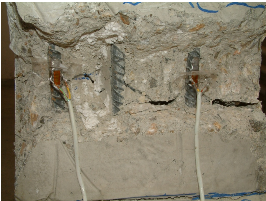
Figura 4.16. Detaliu deschidere fisură în zona întinsă pentru elementul C1M (35kN)
