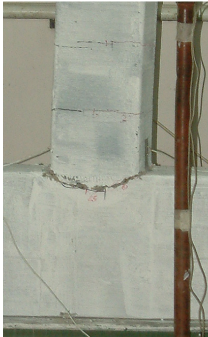
Figura 4.42. Secțiunea de lunecare la baza înfășurării în finalul cedării pentru elementul C1C-CW-BC
