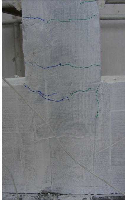
Figura 4.24. Distribuția fisurilor la baza elementului pentru elementul C1C
