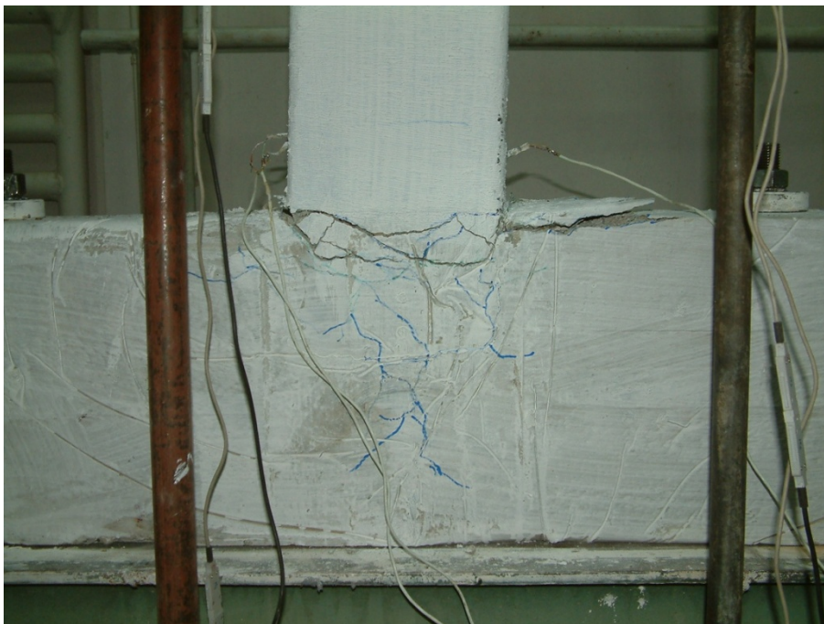
Figura 4.119. Fisurarea bazei elementului C4C-BM+CW
