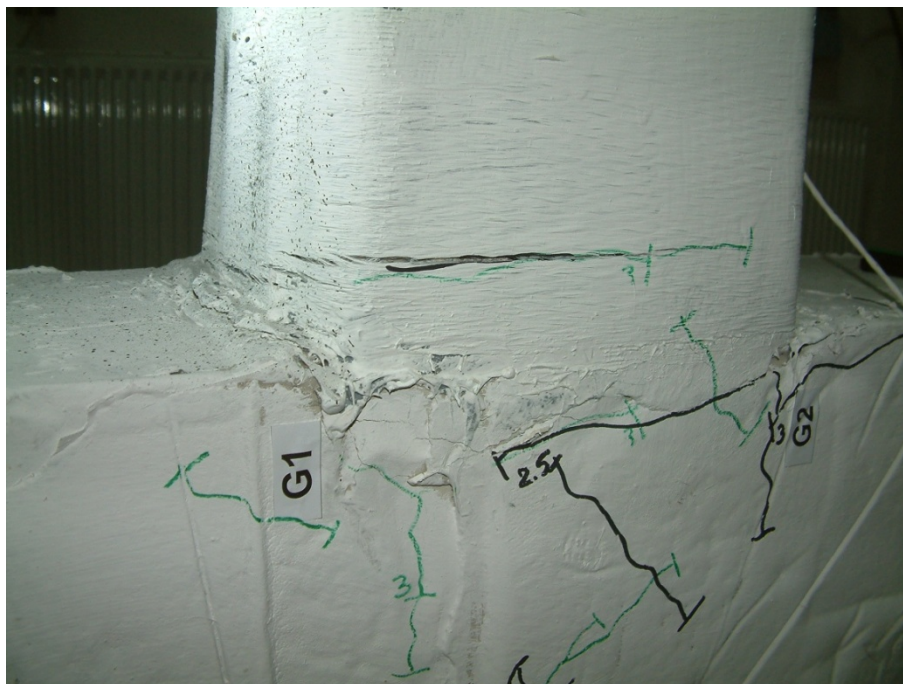
Figura 4.152. Formarea secțiunii de fisurare la baza consolidării pentru elementul C9C2-CSS-AF
