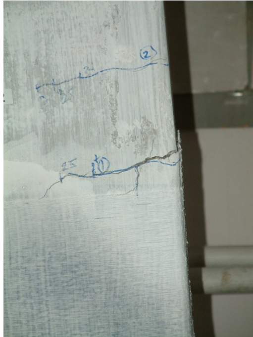
Figura 4.110. Inițierea cedării secțiunii la partea superioară a consolidării laterale pentru elementul C4M-BM+CW
