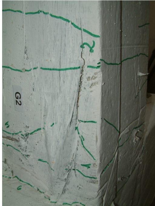
Figura 4.85. Fază inițială desprindere consolidare laterală (în compresiune) pentru elementul C8C1-CSS-AF
