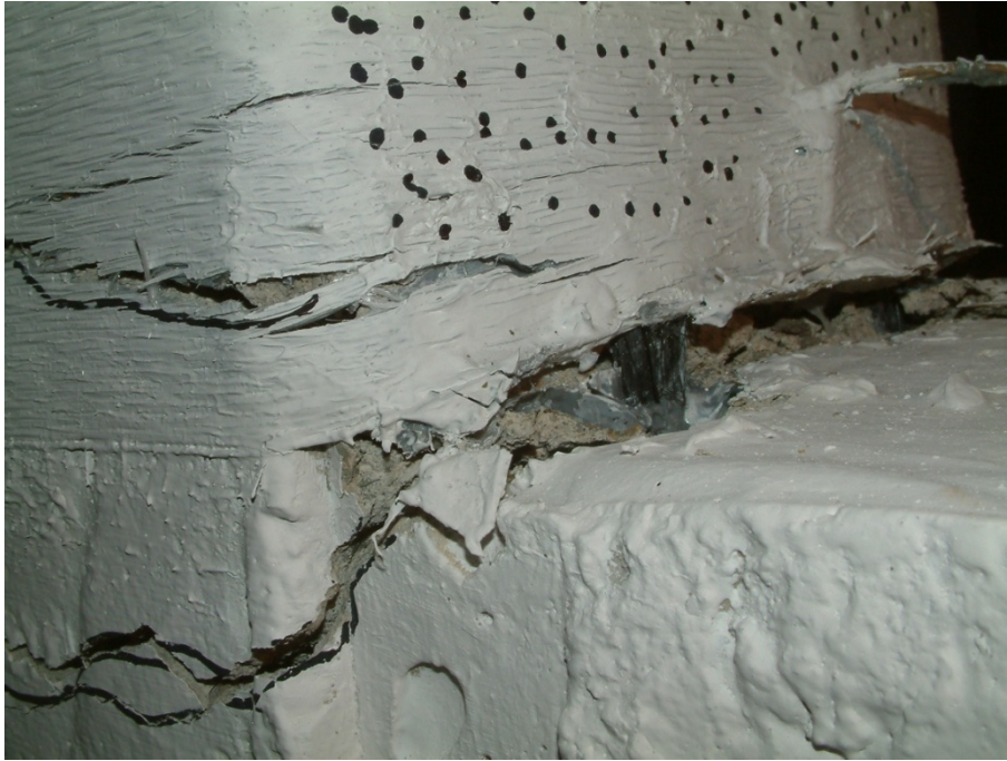
Figura 4.146. Inițiere cedare consolidare laterală întinsă pentru elementul C9C1-CSS-AF
