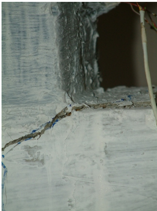
Figura 4.109. Inițierea cedării secțiunii la baza consolidării elementului C4M-BM+CW
