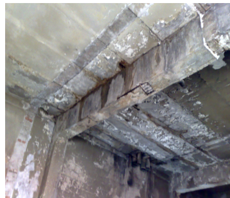
Degradarea structurii datorită mediului agresiv din trecut
