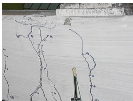
Cedarea betonului în zona comprimată
