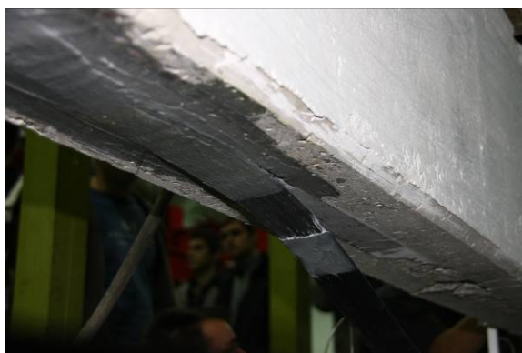
Dezlipirea lamelei și smulgerea din ancoraj
