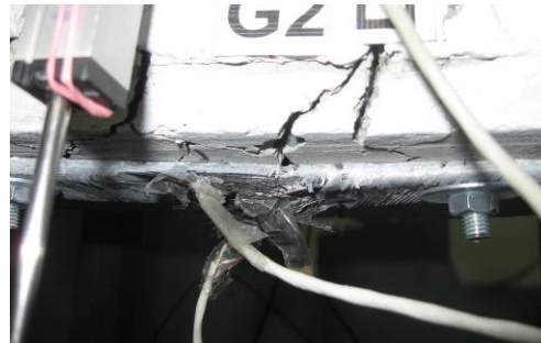
Distrugerea lamelei la mijloc
