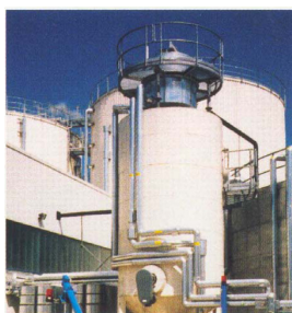
Figura 3.18 Instalație de biogaz
