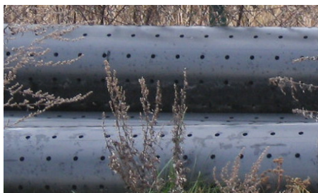
Fig. 3.42 Vedere conducte de drenaj a levigatului
