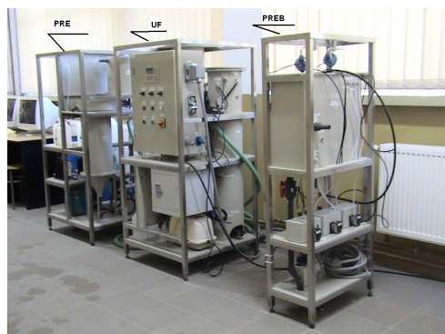
Fig. 5.40 Stația pilot ZW-10 pentru epurarea levigatului
