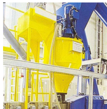
Fig. 3.5 Vederea unei instalații cu hidrociclone
