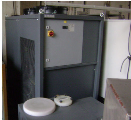
Figura 3.16 Instalație de răcire a circuitului secundar
