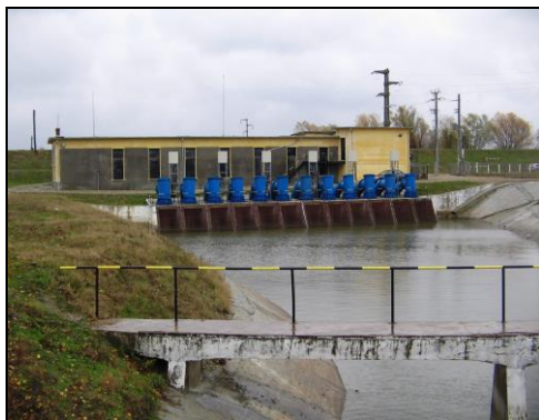
Fig. 4.56: Stația de pompare Cruceni
