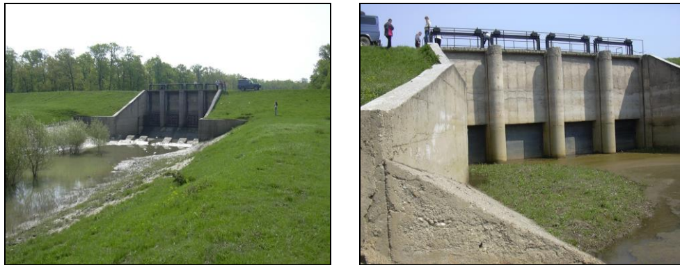
Fig. 4.46: Stăvilar acumulare Pădureni
