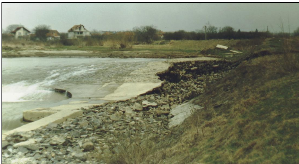
Fig. 4.12: Eroziune de mal în zona de încastrare a barajului deversor Coștei, 1999 [sursă: Arhiva Administrației Bazinale de Apă Banat]
