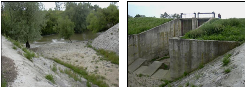
Fig. 4.43: Stăvilarul de golire de pe canalul descărcător Bega-Timiș
