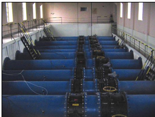
Fig. 4.57: Sala pompelor S.P. Cruceni
