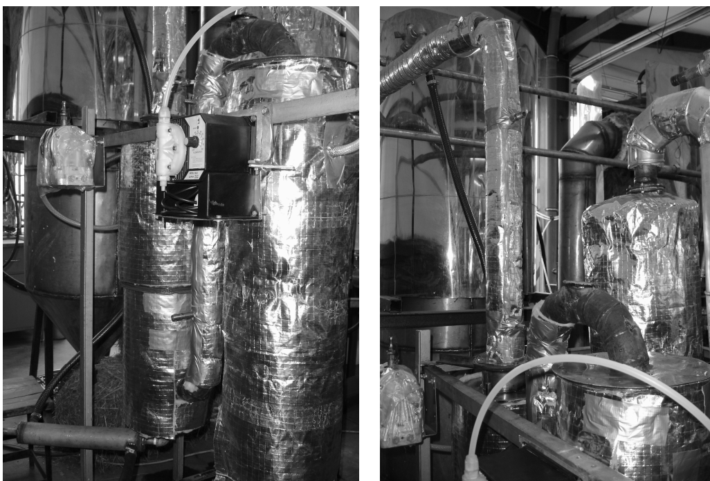
Figura 5.3. Sistemul de reținere \text{SO}_2/\text{CO}_2 din gazele de ardere (în stânga) coloana de desulfurare și de absorbție, și (în dreapta) vederea de sus a coloanelor
